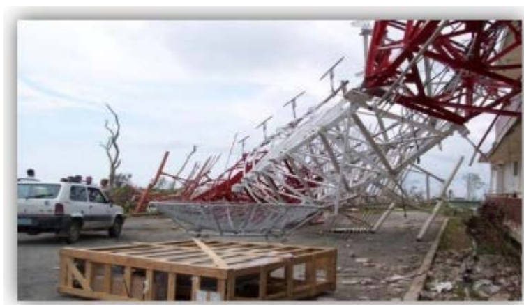
Imagen 1.9 Colapso de torres
