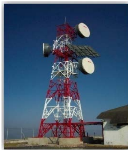
Imagen 1.11 Torre autosoportada Base cuadrada
