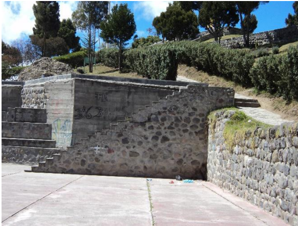
Fig. 228. Pendientes peligrosas FUENTE: Grupo de trabajo.
