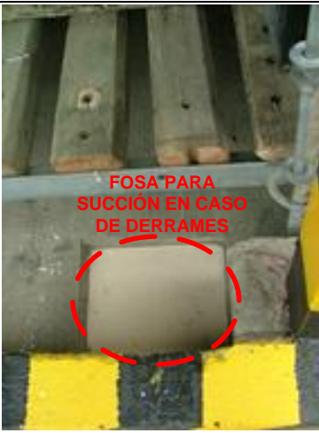
Fotografía III.2. Fosa para derrames
