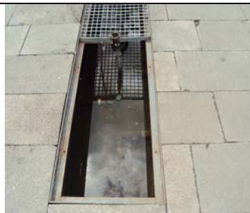
Pileta sin cobertura
