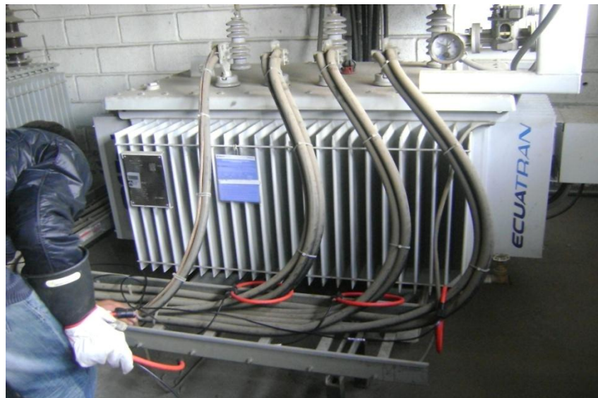
Figura 11. Instalación del Medidor de Calidad de Energía en el Transformador
