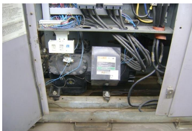
Figura 9. Compresor del equipo de refrigeración.
