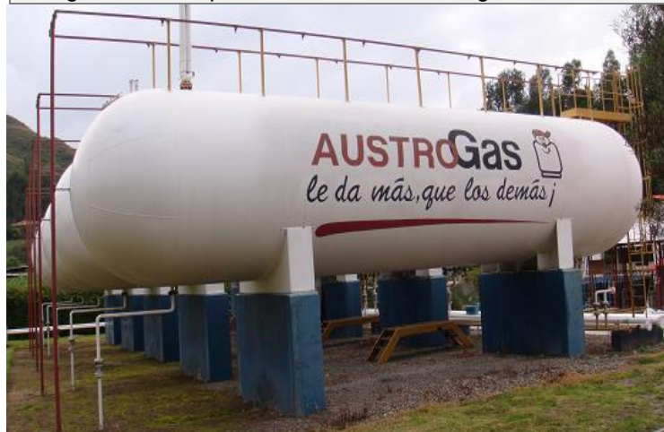
Fotografía 1: Tanques estacionarios Austrogas.
