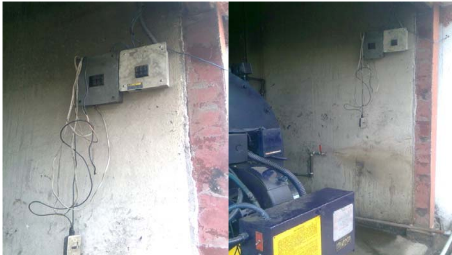
Gráfico 4.8: Instalaciones eléctricas cercanas al caldero.
