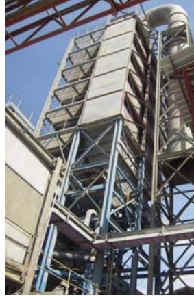
Figura 24. Enfriador aire-aire F24 Fuente. Departamento de procesos de Compañía Industrias Guapán
