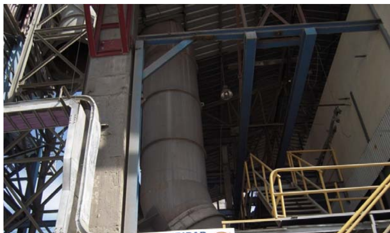
Figura 30. Ducto de gas Torre de enfriamiento
