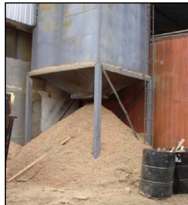
Descarga del extractor
