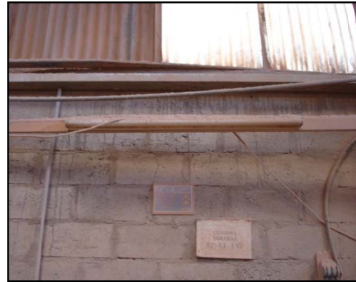
Lámpara utilizada para iluminación localizada, recubierta de polvo.
