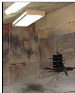
Cabina de lacado
