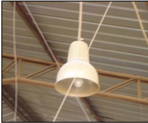
Tipo de lámparas utilizadas para la iluminación general de la planta.
