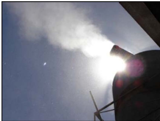
Sistema de extracción de polvo
