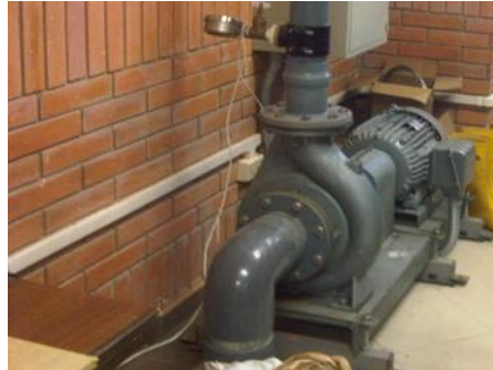
Foto 3.1 Bomba eléctrica Brook Crompton
