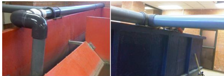
Foto 3.2 Tuberías para recirculación
