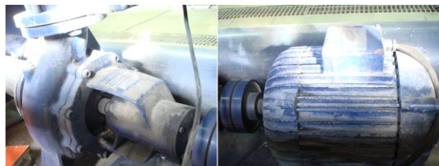
Foto 3.6 Bomba NECO de 4 HP de potencia
