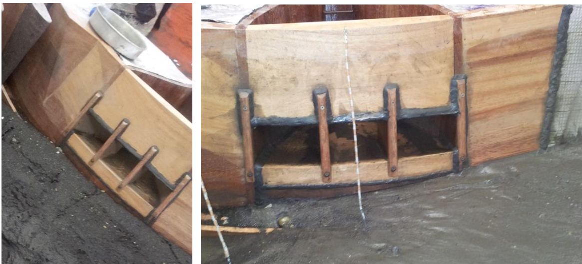
Figura 4.13. Azolvamiento en canal de lavado y elevación del lecho
