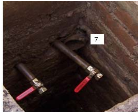
Foto X-30 Desagüe del Filtro 2 a la Cámara de Desagüe.
