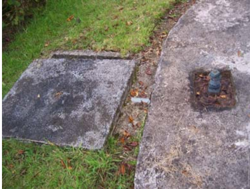
Foto X-27 Cámara de Desagüe del Tanque de Almacenamiento.
