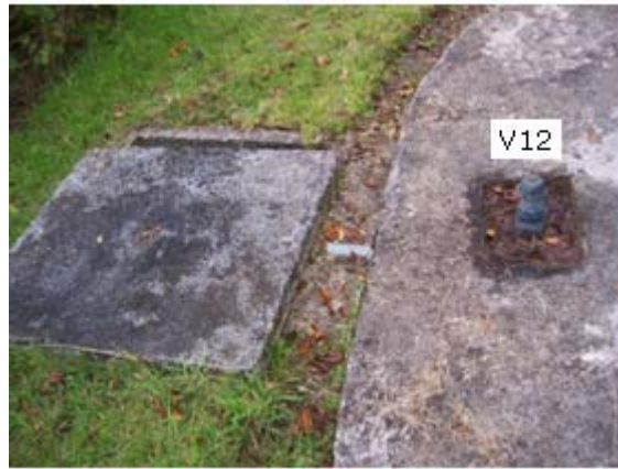
Foto X-24 Válvula para Limpieza del Reservorio.
