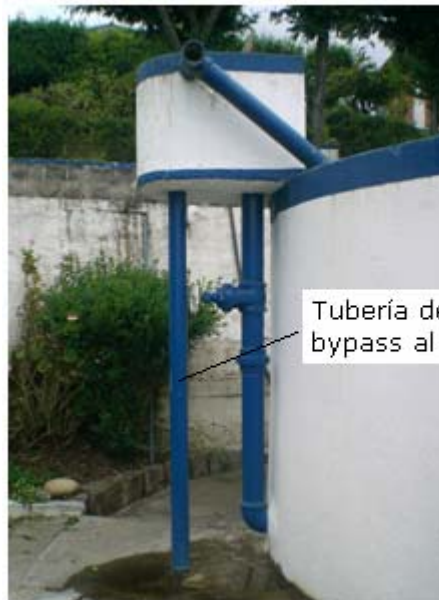
Foto X-6 Tubería Bypass al Filtro Grueso
