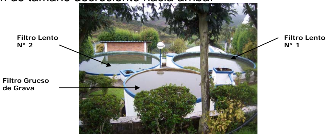
Foto II-13 Vista del Filtro Grueso y los Filtros Lentos de Arena
