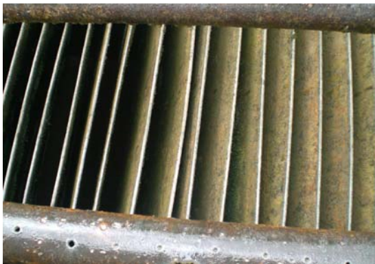
Foto IX-9 Placas del sedimentador con separación variable.
