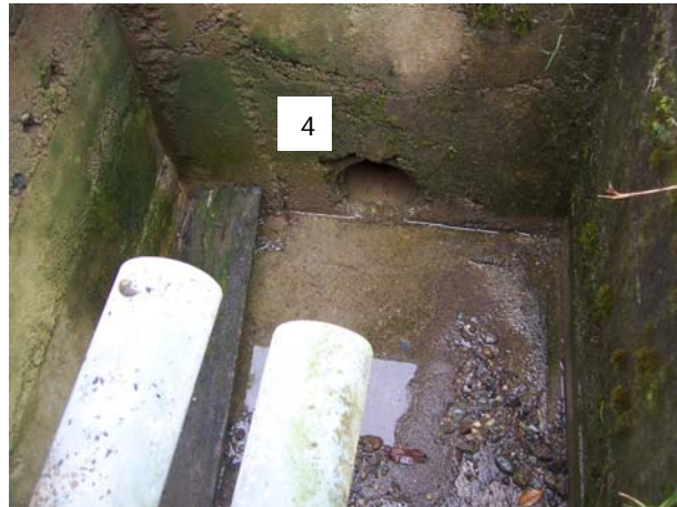
Foto X-36 Tubería de Salida de la Cámara de Desagüe del Tanque de Almacenamiento
