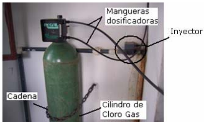
Foto X-48 Accesorios del Dosificador de Cloro Gas
