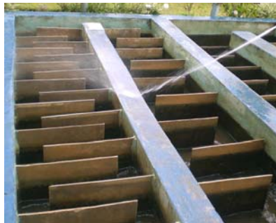
Foto IX-5 Paredes y fondo del floculador se encuentran percudidos por el hierro.
