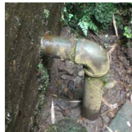
Foto V-18 Tubería de salida de la Captación 4
