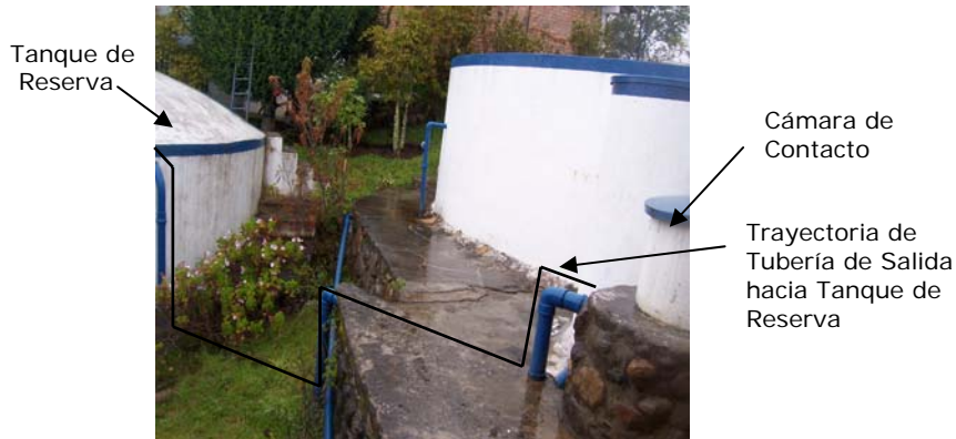
Foto X-21 Tubería que lleva el agua clorada al Tanque de Almacenamiento
