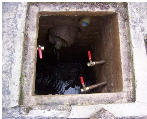
Foto II-17 Cámara de Desagüe de Distintas Unidades.
