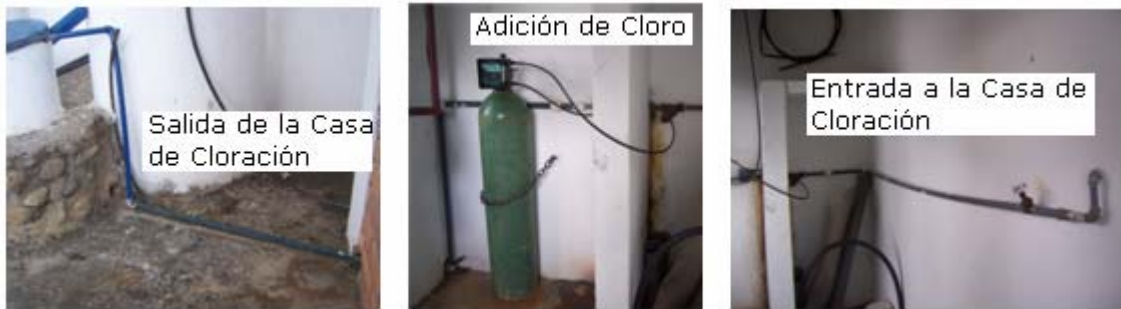
Foto X-19 Tubería que lleva la Solución de Cloro hacia la Cámara de Contacto
