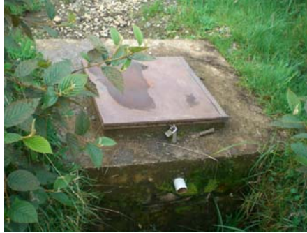
Foto. V-11: Tanque de la Captación 3
