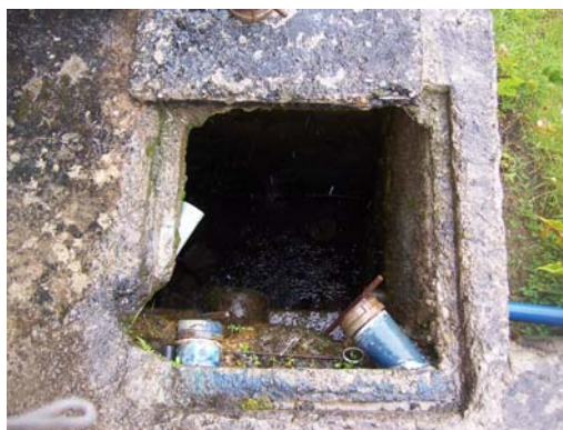
Foto X-26 Cámara de Desagüe de los Filtros Lentos.
