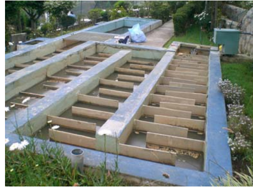
Foto IX-2 Tabiques se encuentran en mal estado.
