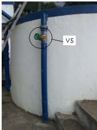
Foto X-8 Válvula V5 y Tubería de Salida del Filtro Grueso al Filtro Lento 1.
