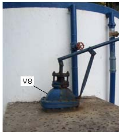
Foto X-11 Válvula V8 de Cierre Rápido para limpieza del Filtro Grueso.
