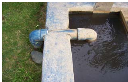
Foto X-2 Detalle de accesorios de tubería de entrada de agua cruda.
