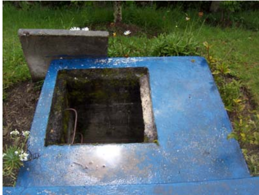
Foto IX-22 Cámara de Desagüe del Floculador y Sedimentador.
