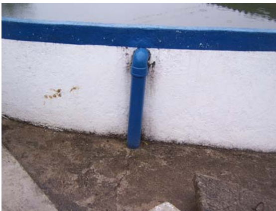
Foto X-29 Tubería de Desagüe del Filtro Lento 2.
