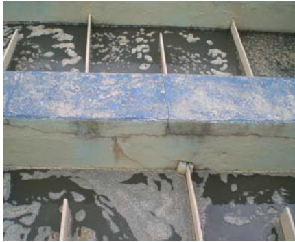
Foto IX-3 Agrietamiento en las paredes internas del floculador.
