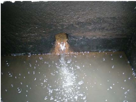
Foto V-12 Detalle de tubería de entrada
