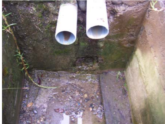
Foto XV-18 Posible Fuga de Agua del Tanque de Almacenamiento
