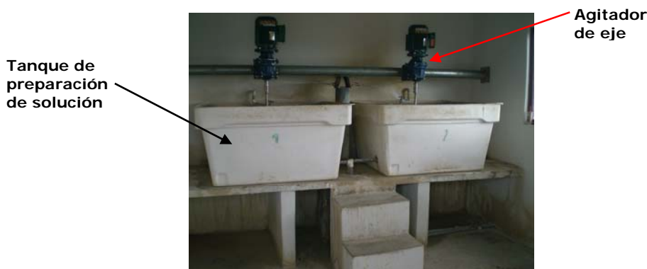
Foto II-26 Tanques de Preparación de Soluciones de Sulfato de Aluminio
