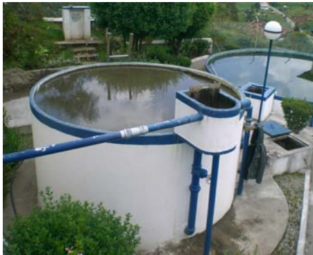
Foto IX-13 Estado Físico del Filtro Grueso
