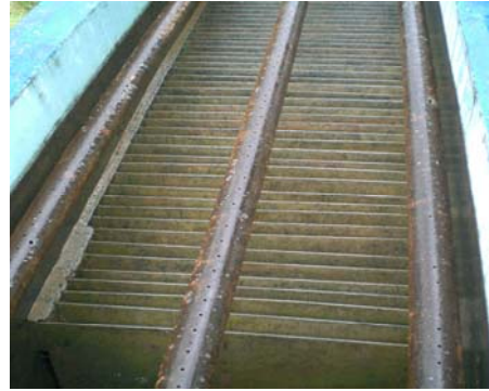
Foto IX-8 Tuberías oxidadas de la Unidad de sedimentación.
