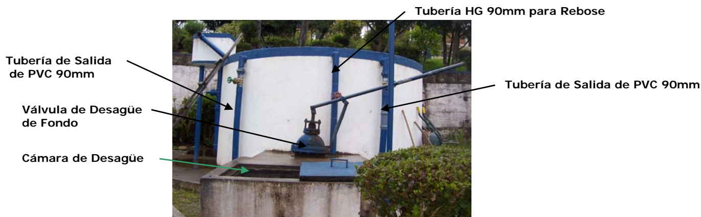
Foto II-11 Salida del Filtro Grueso de Grava y Cámara de Desagüe
