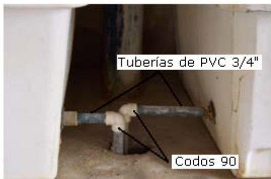
Foto X-43 Tuberías de Salida de los Tanques de Mezcla.
