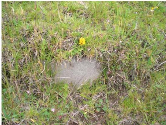
Foto. V-41 Válvula de Purga inundada
