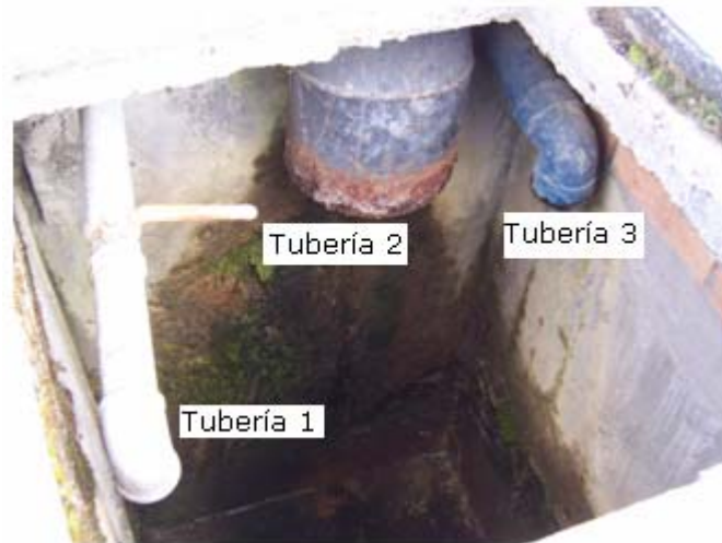
Foto X-26 Tuberías de Desagüe del Filtro Grueso.
