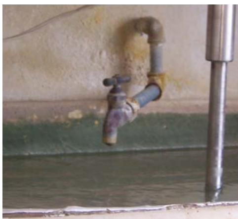
Foto X-42 Llave para llenado de Tanques de Mezcla.
