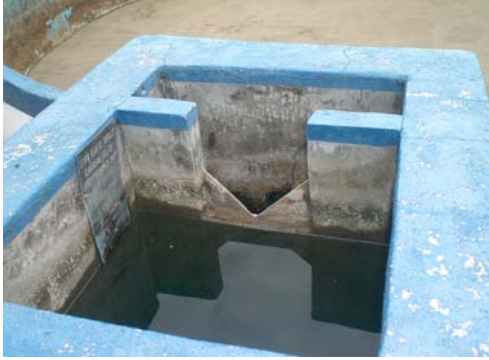
Foto IX-15 Cámara de Entrada del Filtro Lento de Arena.
