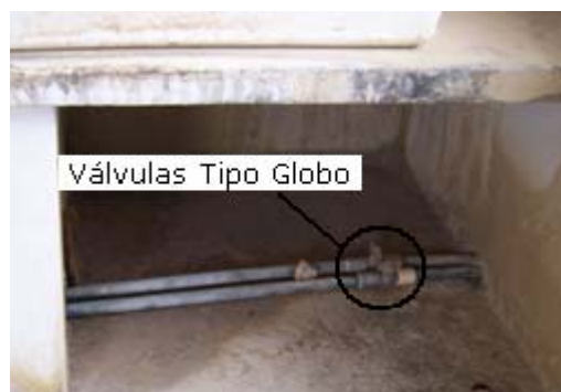
Foto X-44 Válvulas Tipo Globo.
