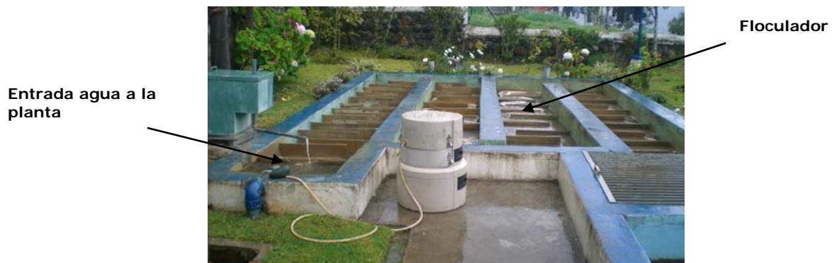
Foto XIII-5 Muestreador colocado a la entrada del floculador
