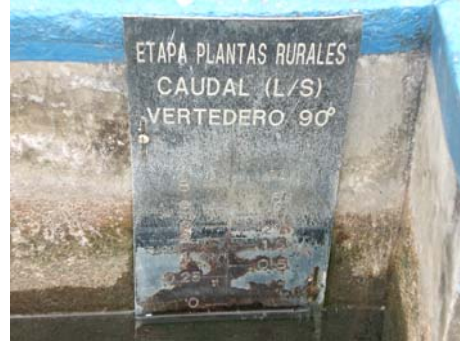
Foto IX-16 Placa medidora de caudal en mal estado.
