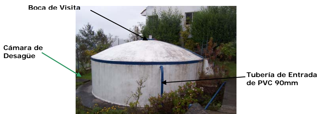
Foto II-21 Tanque de Almacenamiento
