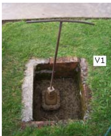
Foto X-1 Válvula para Ingreso del Agua Cruda.
