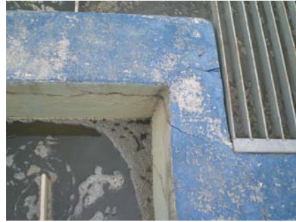
Foto IX-4 Pérdida de la pintura en la parte superior e interna de las paredes.
