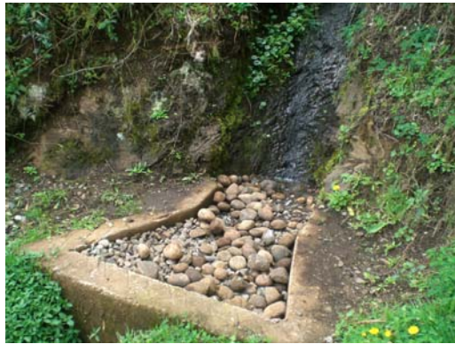
Foto. V-22 Estructura para la Captación 6.
