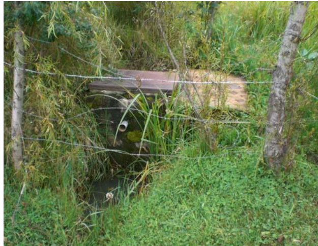
Foto. V-7 Tanque de Presión de la Captación 2
