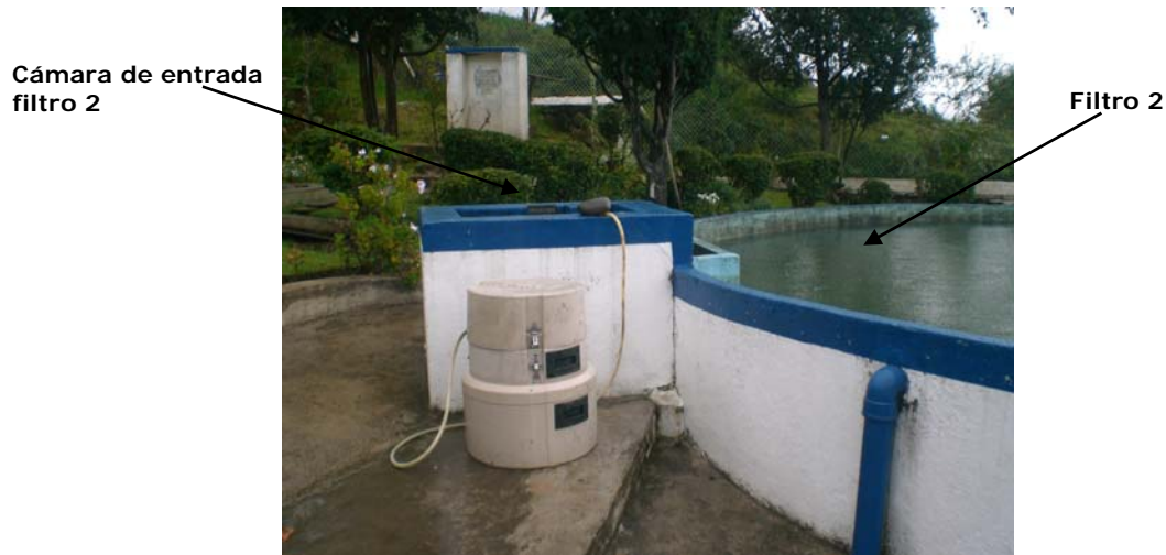
Foto XIII-6 Muestreador colocado a la entrada del filtro lento 2 que corresponde a la salida del filtro grueso.
