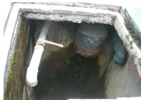
Foto IX-24 Parte interna de la Cámara de Desagüe del Prefiltro.
