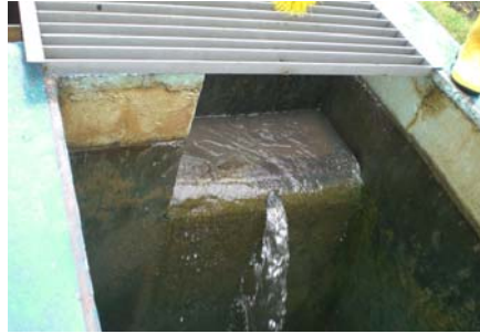
Foto IX-6 Paredes de la cámara de entrada al sedimentador se encuentran afectadas.
