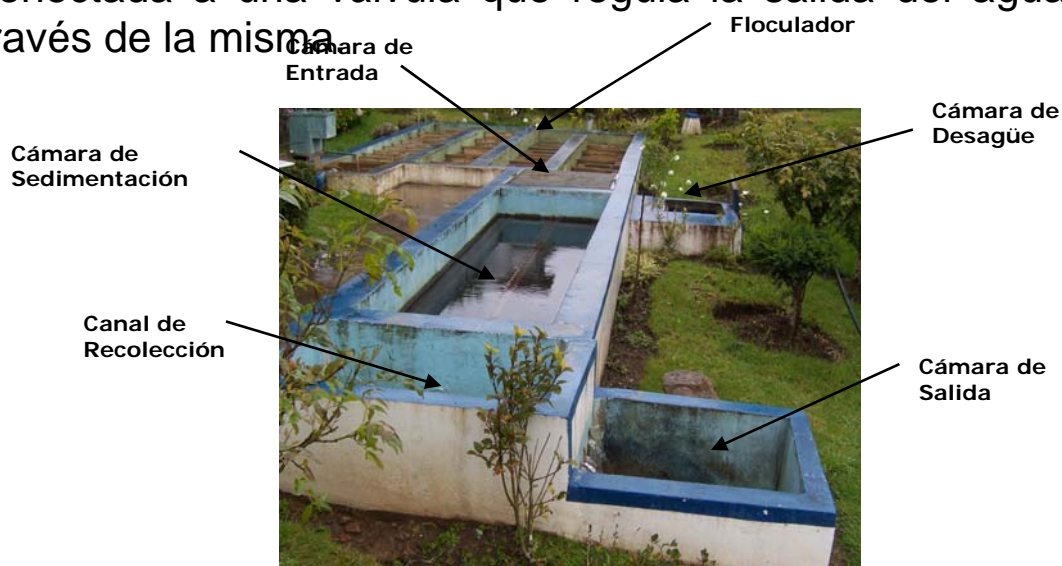
Foto II-5 Unidad de Sedimentación
