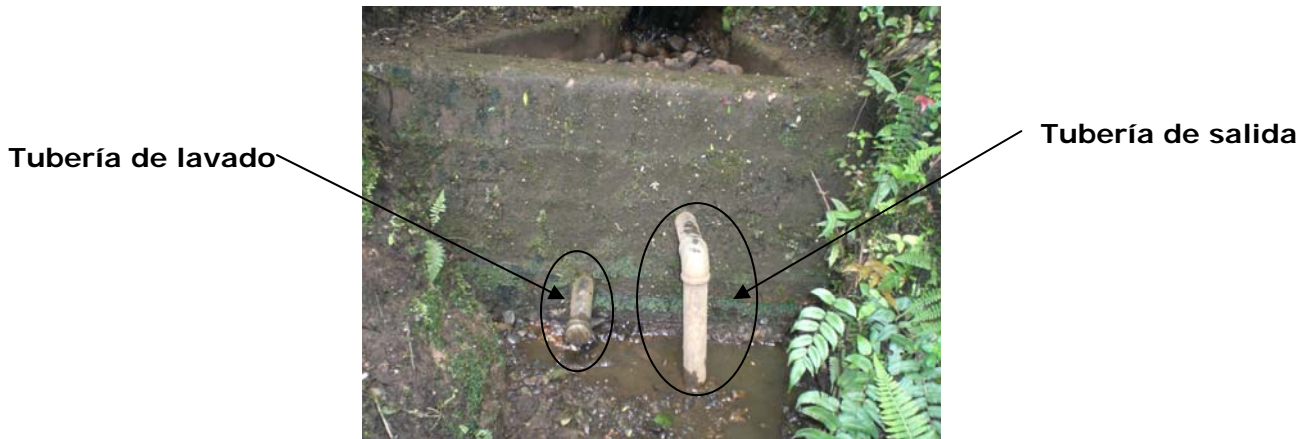
Foto V-27 Accesorios de la Captación 7.
