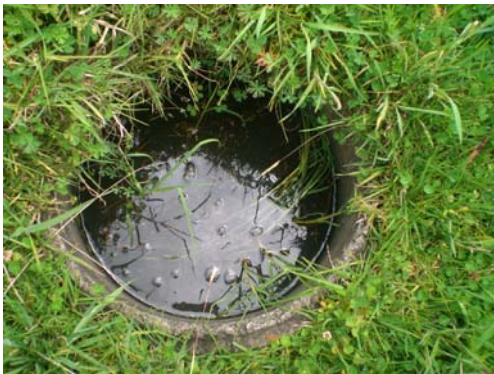
Foto. V-39 Válvula de Purga inundada.
