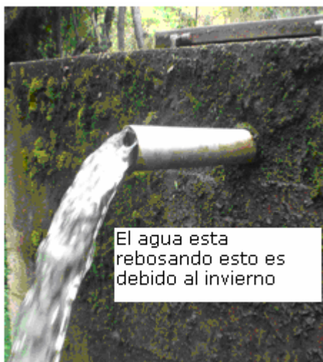
Foto. V-5 Tubería de rebose de PVC 2".
