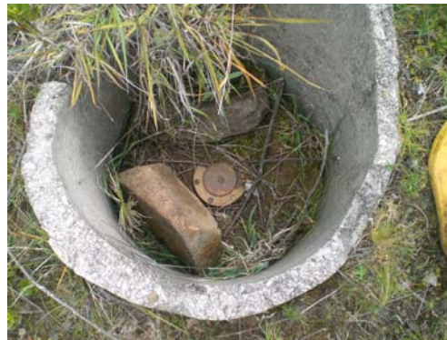
Foto. V-40 Válvula de Aire, actualmente en desuso
