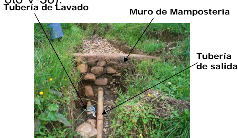
Foto V-36 Accesorios de la Captación 10.
