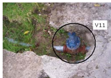
Foto X-22 Válvula V11 de Salida a la Red de Distribución.
