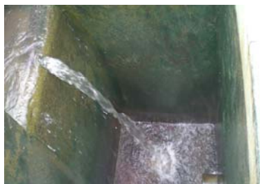
Foto II-3 Cámara de Entrada
