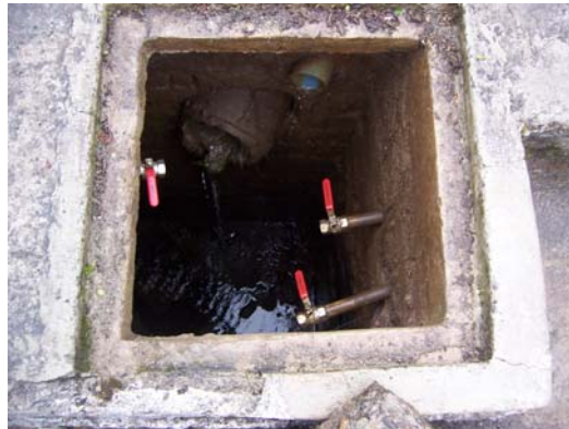
Foto X-25 Cámara de Desagüe de Distintas Unidades.
