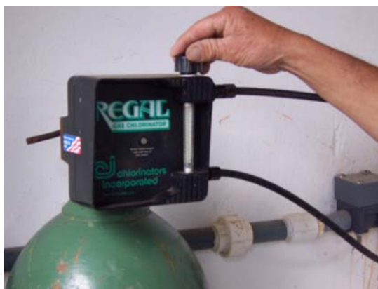
Foto XI-3 Dosificador de Cloro gas.
