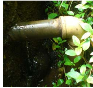
Foto V-21 Tubería de Salida de la Captación 5
