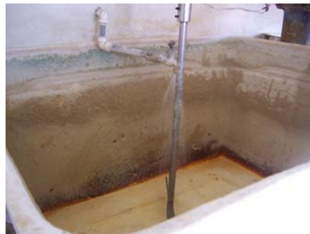
Foto VI-3 Llenado del Tanque con Agua Tratada
