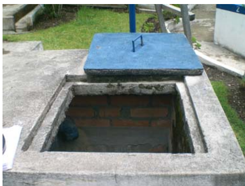
Foto II-12 Cámara de Desagüe del Filtro Grueso.
