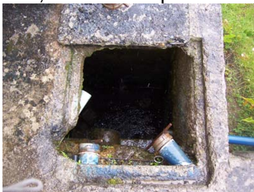
Foto II-18 Cámara de Desagüe de los Filtros Lentos.
