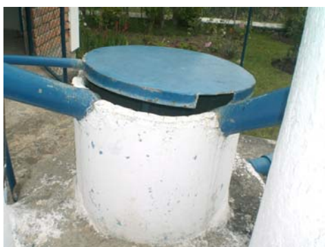
Foto II-19 Cámara de Contacto con el Desinfectante.
