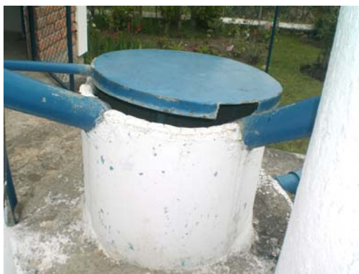
Foto XI-2 Tanque de Cloración.
