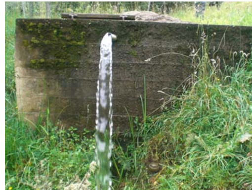
Foto. V-3 Vista frontal del tanque de presión de la captación 1.
