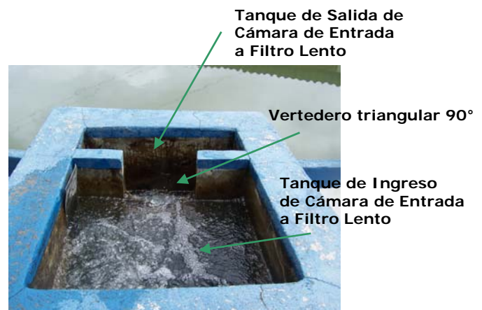
Foto II-15 Detalle de Cámara de Entrada a Filtro Lento
