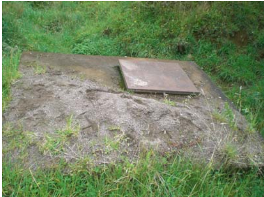
Foto. V-2 Tanque de Presión de Hormigón con tapa metálica.
