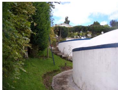
Foto XV-9 Camino al rededor del Filtro Lento 1 y Tanque de Almacenamiento
