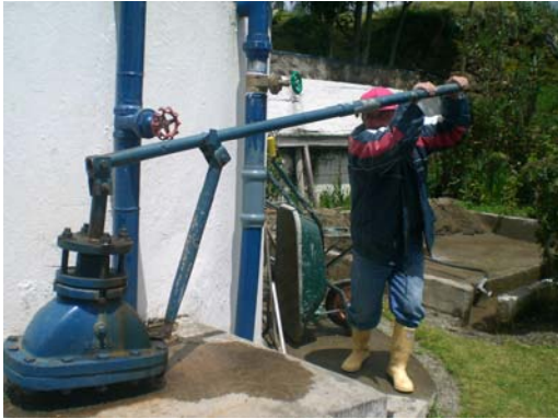
Foto VI-11 Operado abriendo la Vaciado de agua en la válvula de desfogue de fondo. desfogue del Prefiltro
