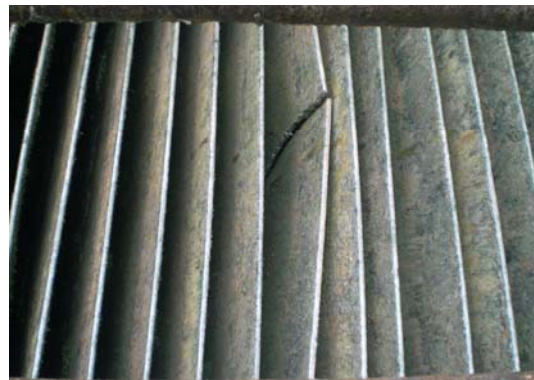
Foto IX-10 Placa rota en la unidad de Sedimentación.
