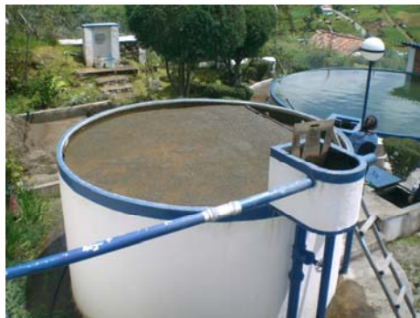
Foto VI-13 Filtro Grueso Vacío
