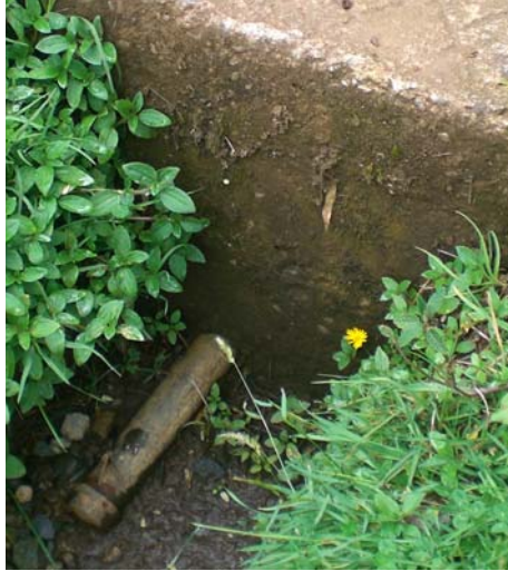
Foto. V-25 Tubería para el lavado y tapón.
