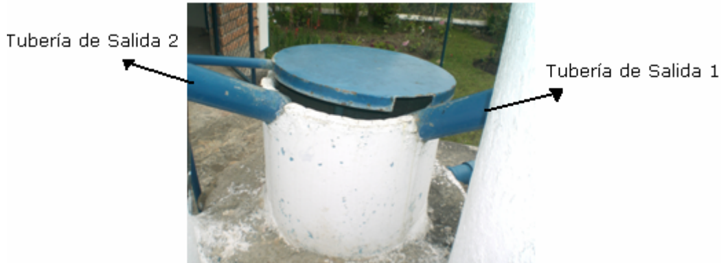
Foto X-17 Tuberías de salida de los Tanques de Salida de los Filtros.
