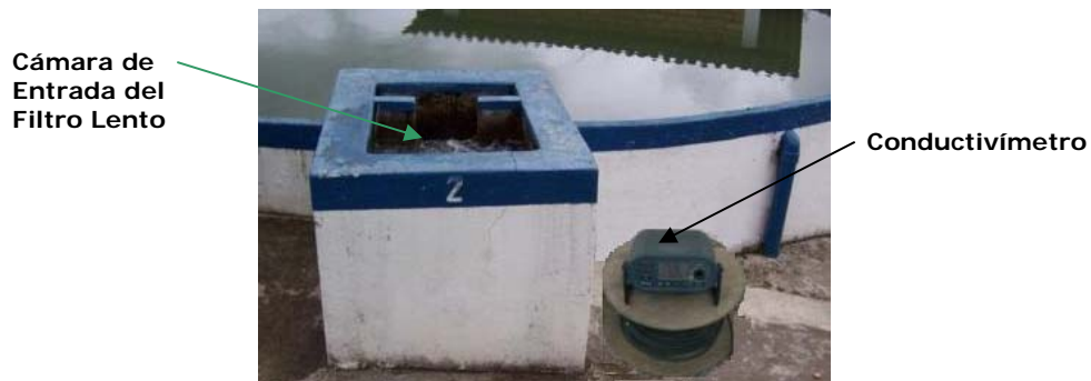
Foto VII-9 Medida de la conductividad a la salida del filtro grueso en la cámara de entrada al filtro lento
