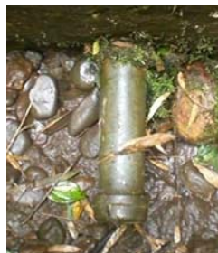
Foto V-17 Tubería de HG de 2" y tapón.
