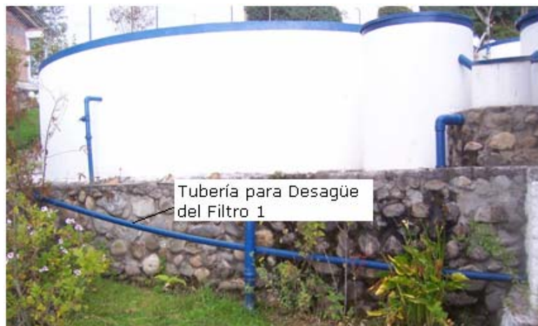
Foto X-14 Tubería de Desagüe del Filtro 1
