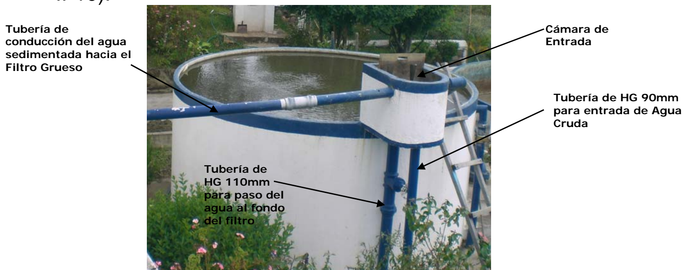
Foto II-10 Entrada a Filtro Grueso de Grava
