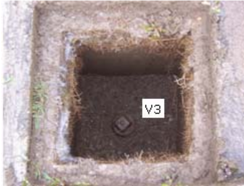
Foto X-5 Válvula V3 Bypass al Filtro Grueso
