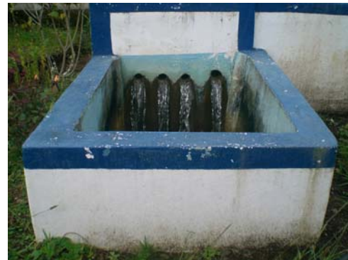
Foto IX-12 Paredes interiores de la cámara percutidas.
