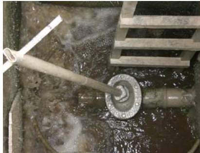
Foto VI-8 Válvula de desfogue evacuando el agua sucia
