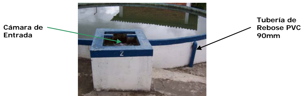
Foto II-16 Cámara de Entrada Filtro Lento 2 y Tubería de Rebose
