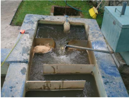
Foto IX-1 Vertedero a la entrada de la planta se encuentra oxidado.
