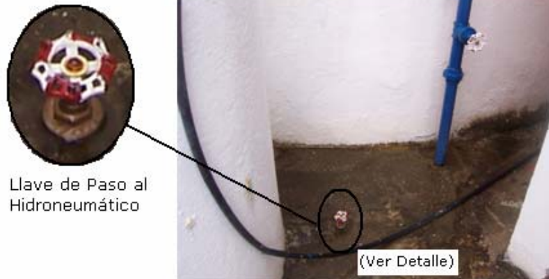
Foto X-18 Llave que permite el paso del agua filtrada al Hidroneumático.
