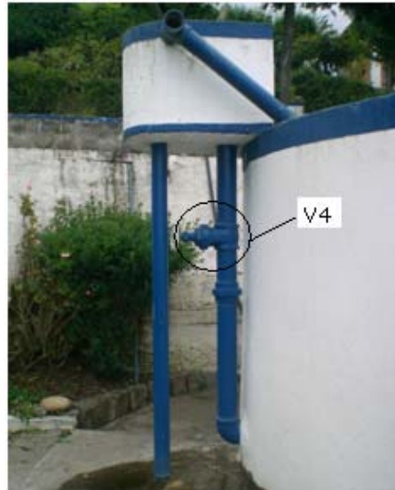
Foto X-7 Válvula de Ingreso de Agua Sedimentada al Filtro Grueso
