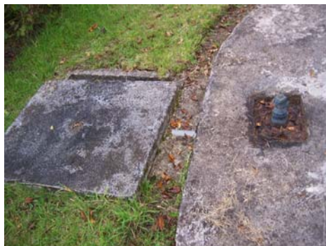
Foto II-22 Cámara de Desagüe del Tanque de Almacenamiento.
