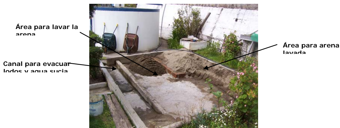
Foto II-30 Unidad de Lavado de Arena
