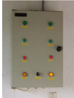
Foto VI-5 Tablero de Control de Mezcla
