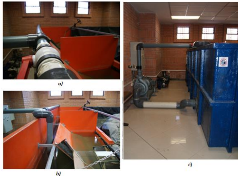
Figura 3-3. a) línea de succión y descarga. b) tanques de reserva. c) equipo de bombeo
