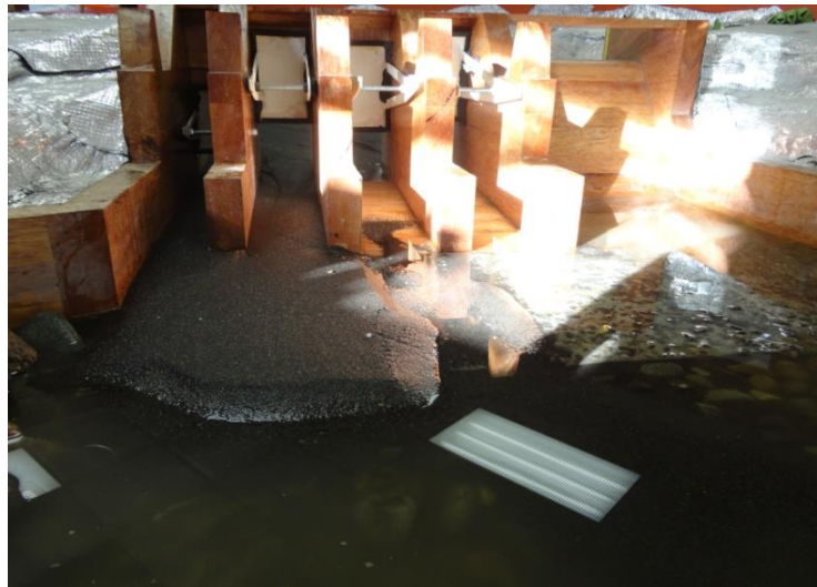
Figura 3-20. azolvamiento en la compuerta de lavado.
