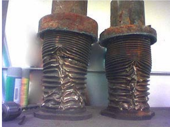
Fotografía 6.2 Material destruido por un golpe de Ariete
