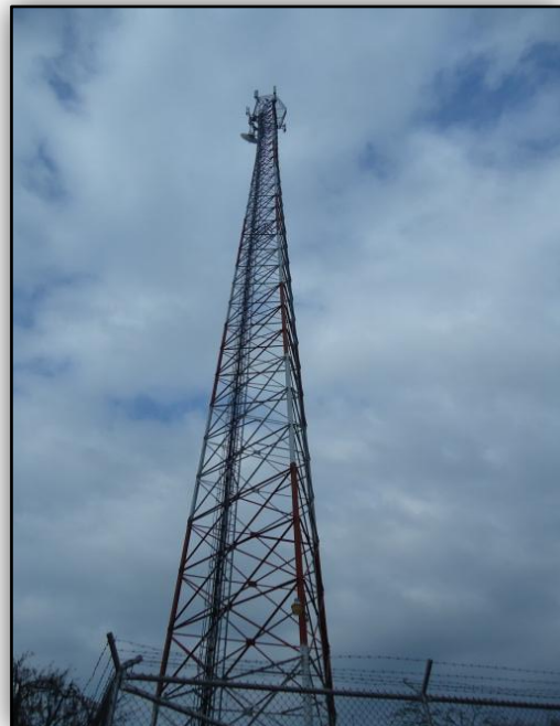
Foto 27. Antena de enlace microonda CLARO Elaborado por: Arq. Fabiola Segarra Gómez
