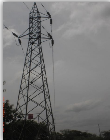
Foto 29. Estructura de línea de sub-transmisión Elaborado por: Arq. Fabiola Segarra Gómez
