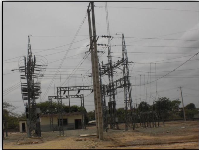
Foto 30. Sub estación Eléctrica Arenillas Elaborado por: Arq. Fabiola Segarra Gómez
