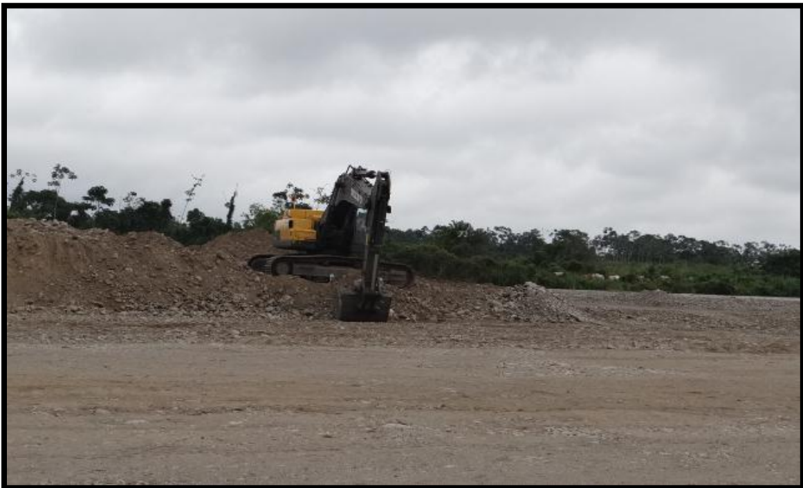
Fotografía 7. Excavación y obtención de material granular en el margen del río Cañar.
