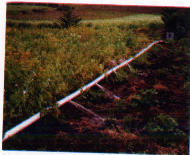
Foto 2. Tubería de compuerta utilizada para suministro de agua a los surcos en terrenos inclinados.
