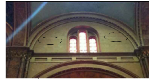
F28: PÉRDIDA DE ADHERENCIA DEL ENLUCIDO
