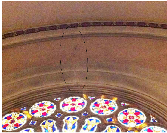
F2: FISURA EN LA PARTESUPERIOR DEL ARCO DEL ROSETÓN
