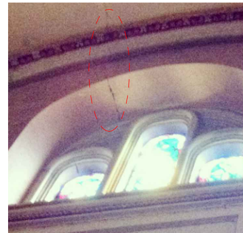
F24: FISURA QUE SE PROLONGA HACIA LA PARTE SUPERIOR DEL ARCO
