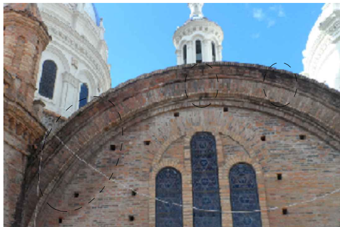
F34: FISURA SOBRE EL ARCO DE LA VENTANA H36: HUMEDAD EN AMBOS EXTREMOS
