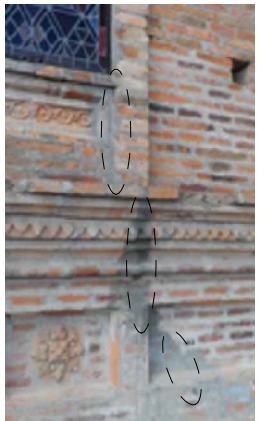
F37: FISURA RELLENADA CON MORTERO DE CEMENTO
