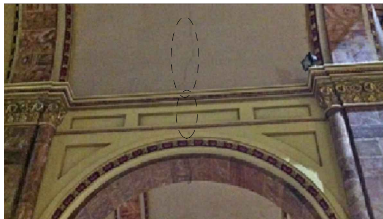
F4: FISURA EN EL ARCO DER. QUE SE PROLONGA HACIA EL DOMO
