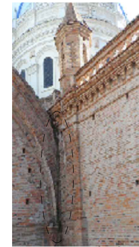
H41: HUMEDAD Y CRECIMIENTO DE VEGETACIÓN EN EL EXTREMO DERECHO
