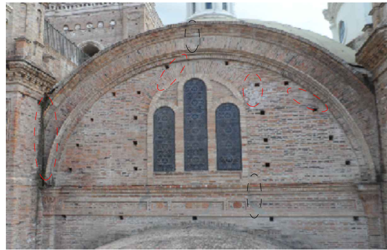
F38: FISURAS EN LA PARTE SUPERIOR Y EXTREMO DERECHO DE LA VENTANA
