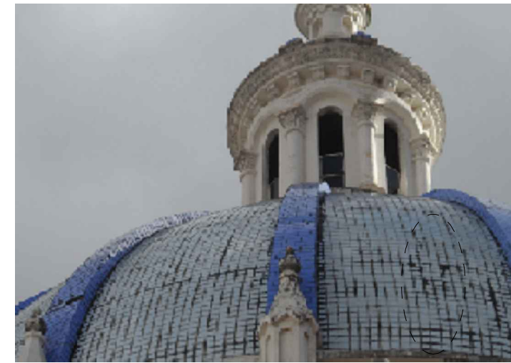
F40: FISURA EN LA SEGUNDA CÚPULA ALTA
