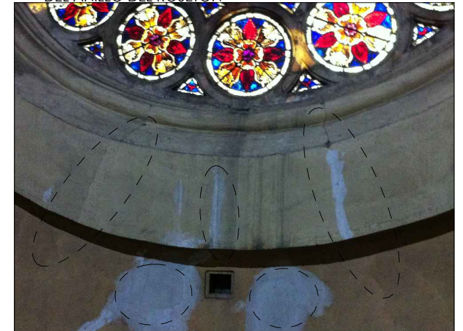
F1: FISURA EN LA PARTE INFERIOR DEL ANILLO DEL ROSETÓN
