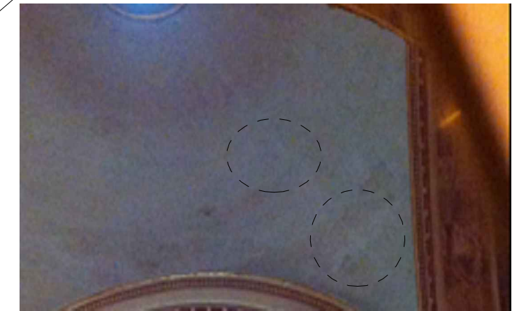
H22: HUMEDAD EN LOS EXTREMOS DE LA CÚPULA
