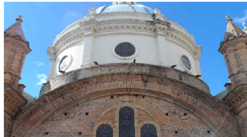
F36: FISURA RELLENADA EN EL INFERIOR DE LA VENTANA
