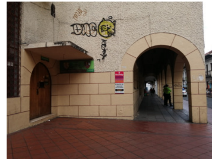
Fig 16. Vandalismo alrededor de la iglesia de San Alfonso
