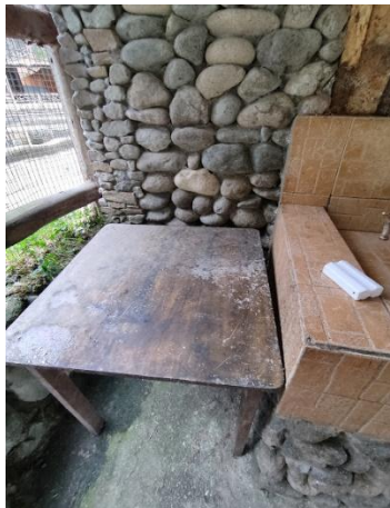
Ilustración 73 Área de lavado de la trucha
