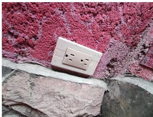
Ilustración 63 Tomacorriente de tres puntas
