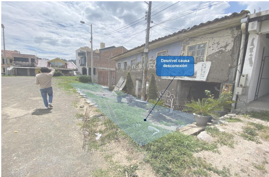
Figura 101. Desnivel en la entrada de un bien patrimonial junto a la plaza Fuente: Elaboración propia
