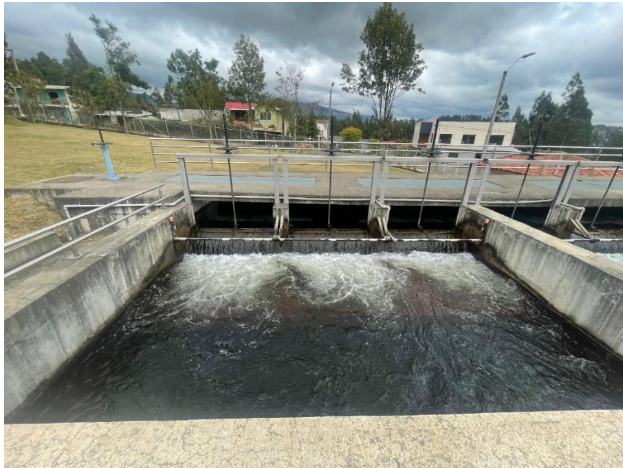
Figura 42. Entrada del agua cruda del río Machángara a la Planta de Tixán.
