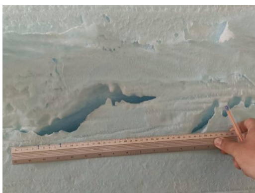
A3. Defecto por rajadura de la espuma
