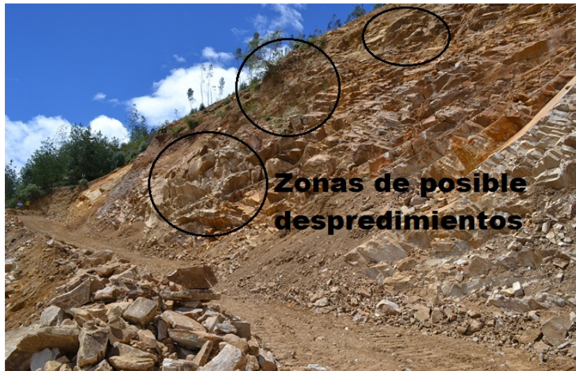
Figura 3.6.: Desprendimientos de roca en la cantera
