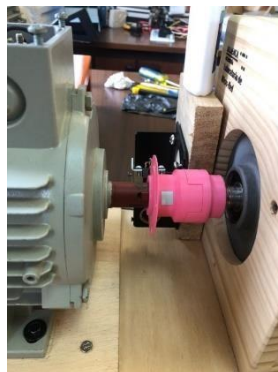
Figura 53. Acople de eje directo del motor y generador
