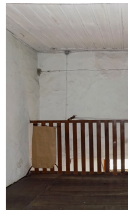
Figura 68 Mezzanine A04: estado de conservación regular
