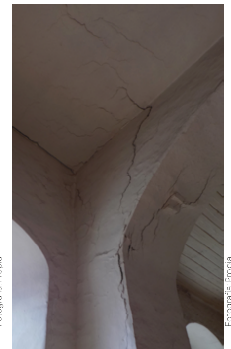
Figura 65 A01: estado de conservación malo
