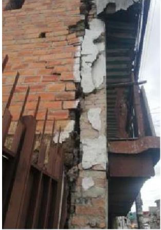
FOTOGRAFIA F1 (GRIETA)
