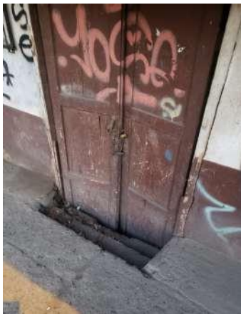
FOTOGRAFIA F4 (HUMEDAD)
