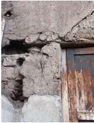
FOTOGRAFIA F4 (FALTANTE EN MURO)
