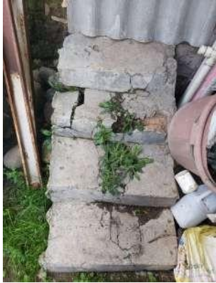
FOTOGRAFIA F2(FALTANTE EN GRADAS)
