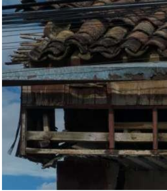
FOTOGRAFIA F1 (FALTANTE CUBIERTA)
