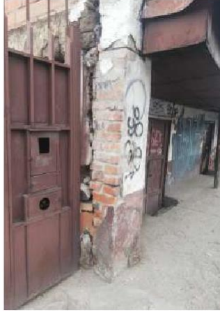
FOTOGRAFIA F2 (GRIETA)
