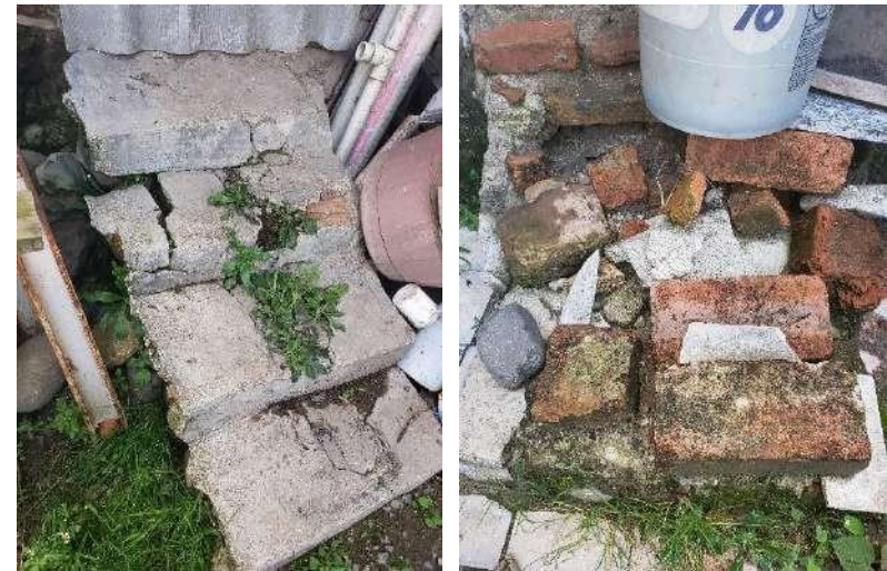
Figura 50. Estado actual de las escaleras de la casa Domínguez. Elaboración: Nicole Valdiviezo León.
