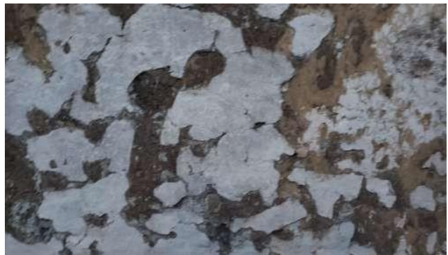
FOTOGRAFIA F4 (DESPRENDIMIENTO EN MURO DE ADOBE)
