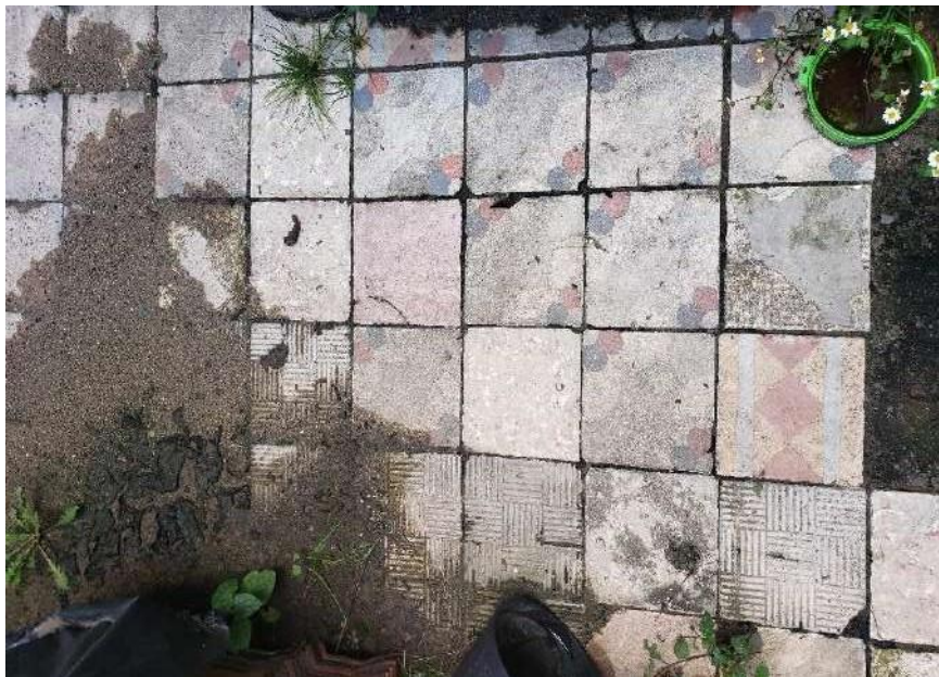
Figura 51. Estado actual de las baldosas de la casa Domínguez. Elaboración: Nicole Valdiviezo León.
