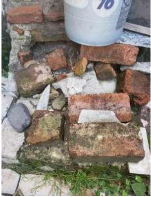
FOTOGRAFIA F1(FALTANTE EN GRADAS)
