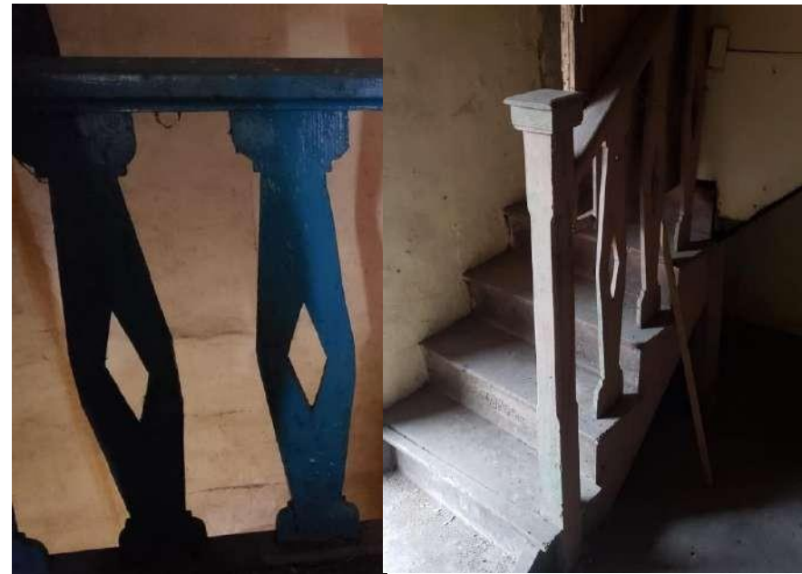
Figura 52. Estado actual de los barandales de la casa Domínguez. Elaboración: Nicole Valdiviezo León.
