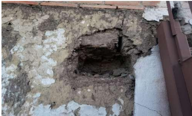
FOTOGRAFIA F3 (FALTANTE MURO DE ADOBE)
