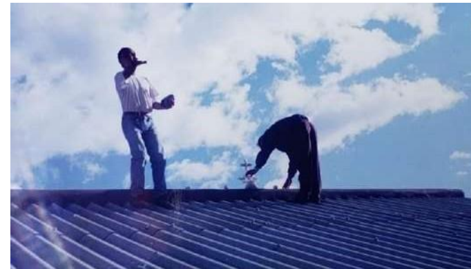
Figura 55. Colocación de cruz de hierro en una vivienda en la Av. Loja. Elaboración: Mónica Vanegas Domínguez.
