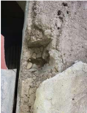
FOTOGRAFIA F3(FALTANTE EN MURO)
