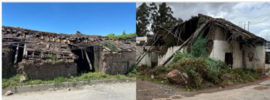
Figura 25. Ejemplo de edificaciones en estado de ruina.
