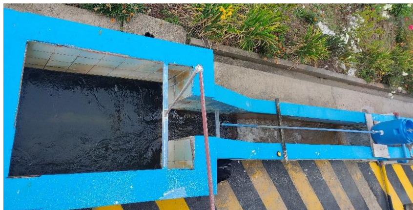
Figura 3 Unidad de mezcla rápida de la PTAP de Nero.
