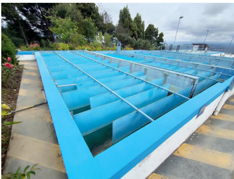
Figura 4. Unidad de floculación de la PTAP de Nero.
