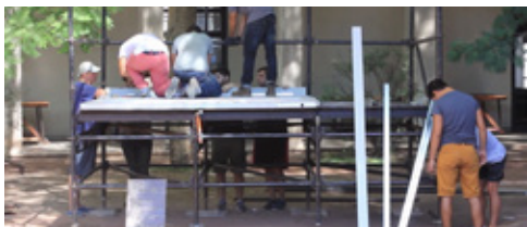
Fig. 3.29 Instalación m4, Fuente: Magnone-López. (2017).
