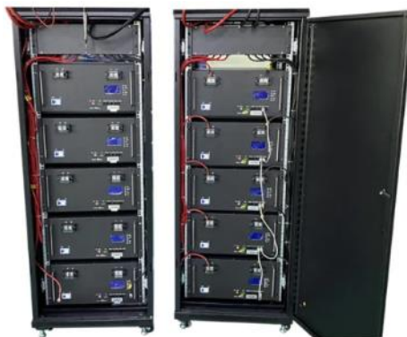
Figura 2.8. Sistema de almacenamiento por batería LiFePO 4 [25].
