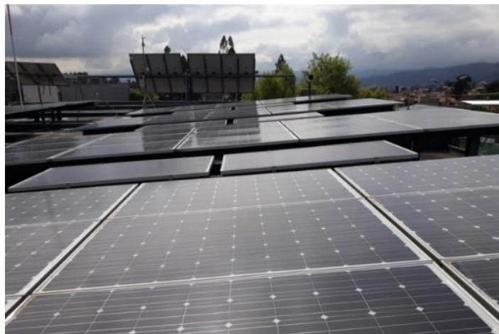
Figura 4.6. Generación fotovoltaica, Micro red Balzay. Elaboración propia.
