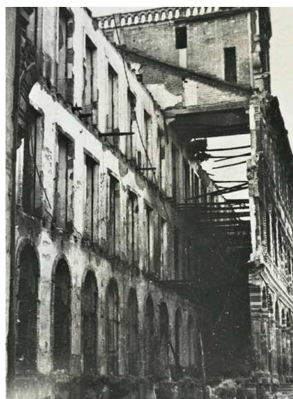
Figura 114 - Fotografía de la estructura remanente, luego del incendio. Sin Autor, 1962. Fuente: Archivo Histórico Fotográfico, Museo Pumapungo.
