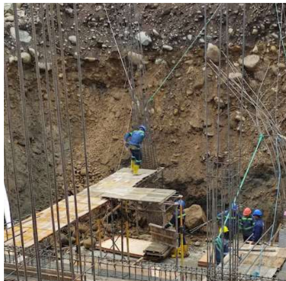
Figura 21. Desprendimiento de talud en obra provocado por las fuertes lluvias, se observa un deslizamiento en forma de desprendimiento de los boleos más grandes. Fuente: Autor.
