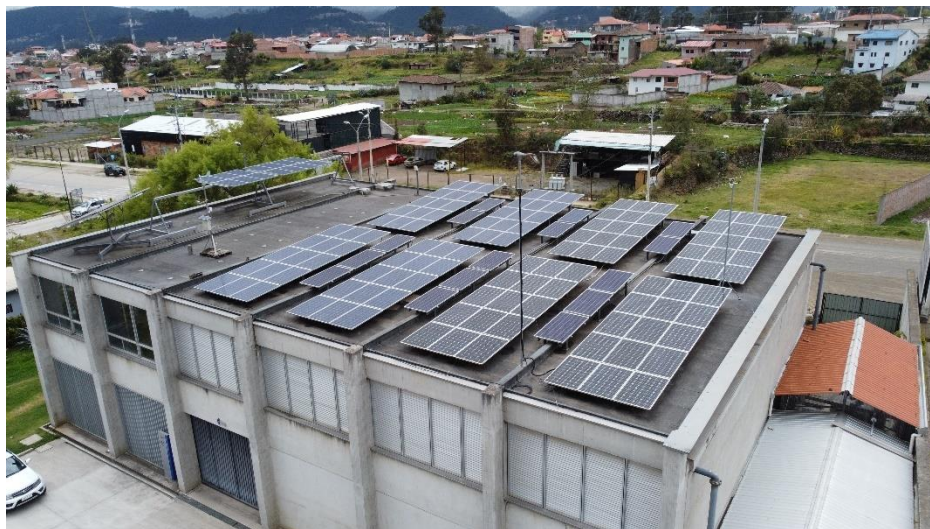
Figura 3.1 Sistema fotovoltaico del Laboratorio de Micro-Red de la Universidad de Cuenca. [Elaboración propia, 2022]
