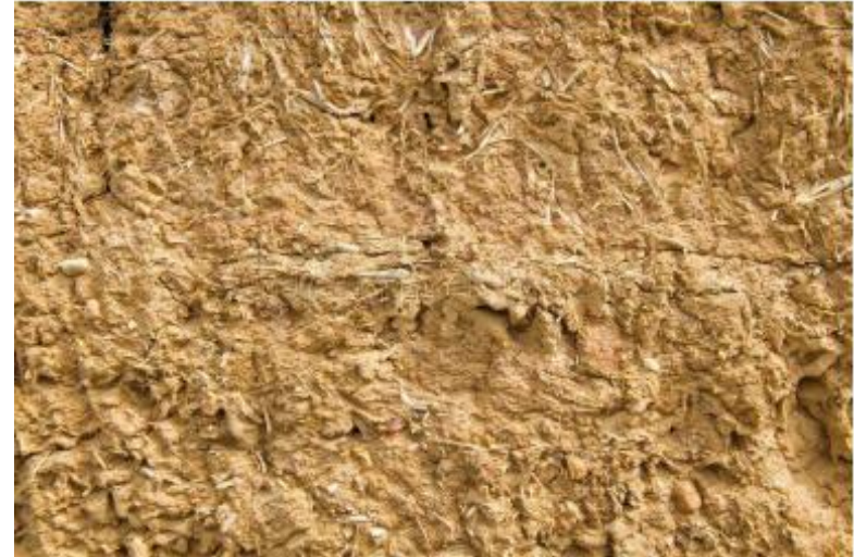
Figura 58. Revocado en muro de adobe (sp.depositphotos.com, 2023)
