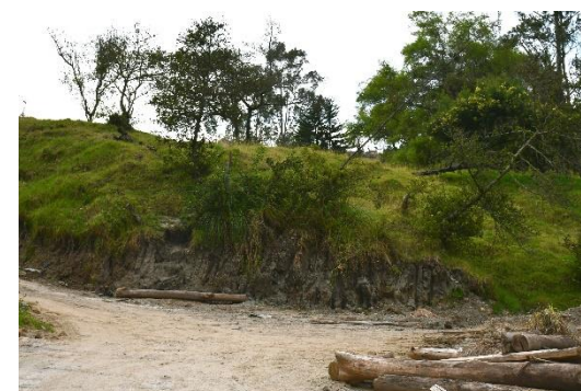
Figura 41: Deslizamiento D5 Fuente: Propia
