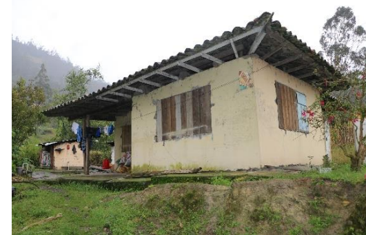
Figura 71. Edificación 02 con patologías Fuente: Propia
