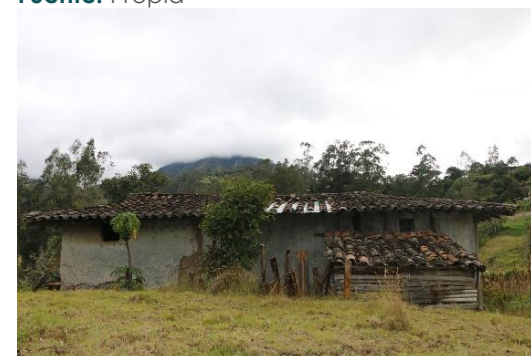
Figura 72. Edificación 03 con patologías Fuente: Propia
