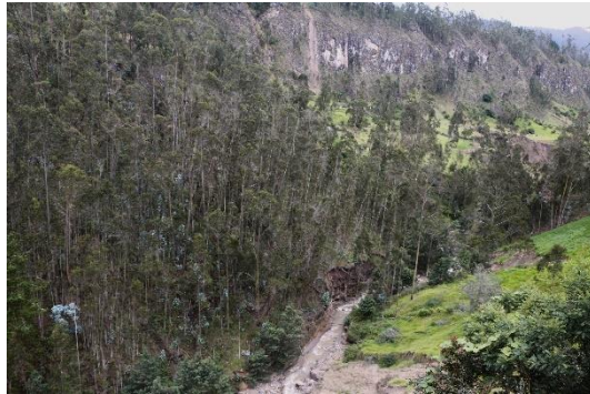
Figura 49: Desprendimiento DS1 Fuente: Propia
