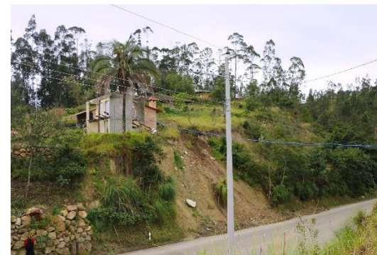
Figura 42: Deslizamiento D6 Fuente: Propia
