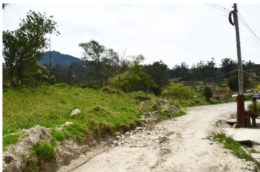
Figura 44: Deslizamiento D8 Fuente: Propia
