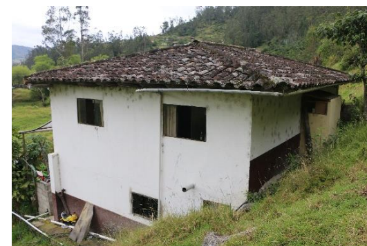
Figura 70. Edificación 01 con patologías Fuente: Propia
