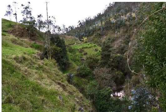
Figura 43: Deslizamiento D7 Fuente: Propia
