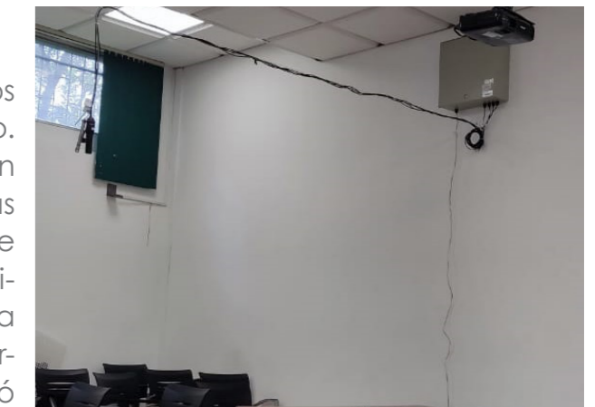
IMAGEN 02 Equipos de medición instalados en aulas. FUENTE: Propia.
