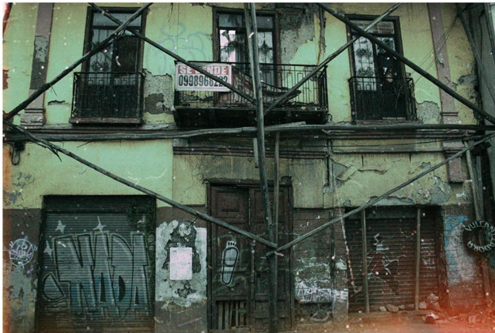
Fotografía 5. Registro fotográfico de una edificación patrimonial en deterioro.
