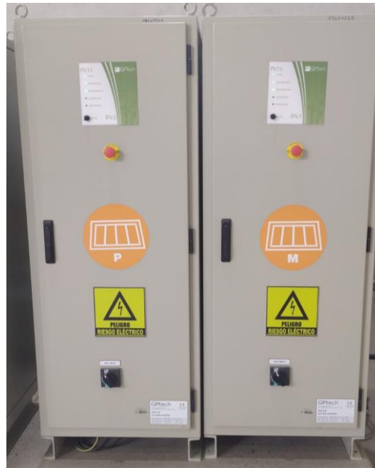
Figura 4.3: Inversores GPTech conectados a paneles policristalinos (izquierda) y a paneles monocristalinos (derecha).
