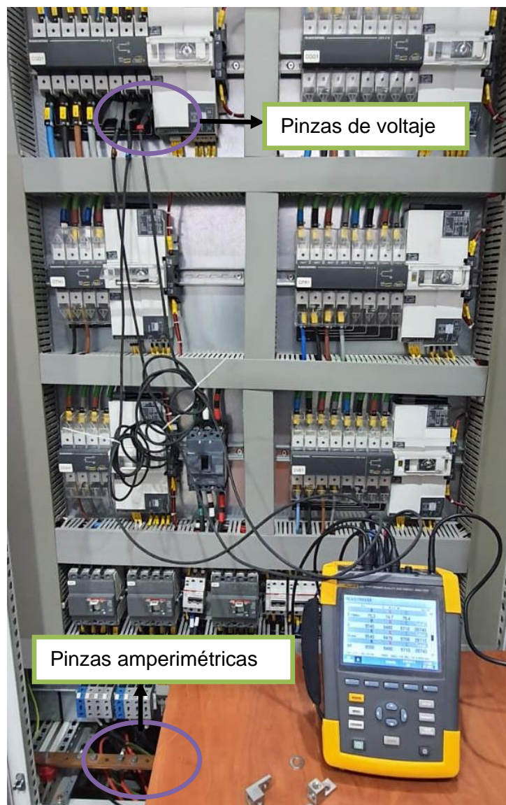
Figura 4.24: Conexión del analizador de calidad de energía en el inversor FRONIUS (IFV3).
