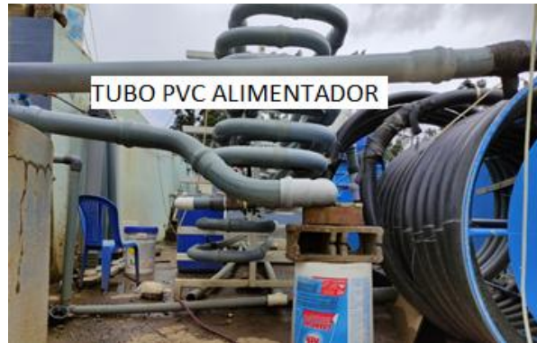
Ilustración 7 TUBO ALIMENTADOR DEL FLOCULADOR HELICOIDAL TUBULAR
