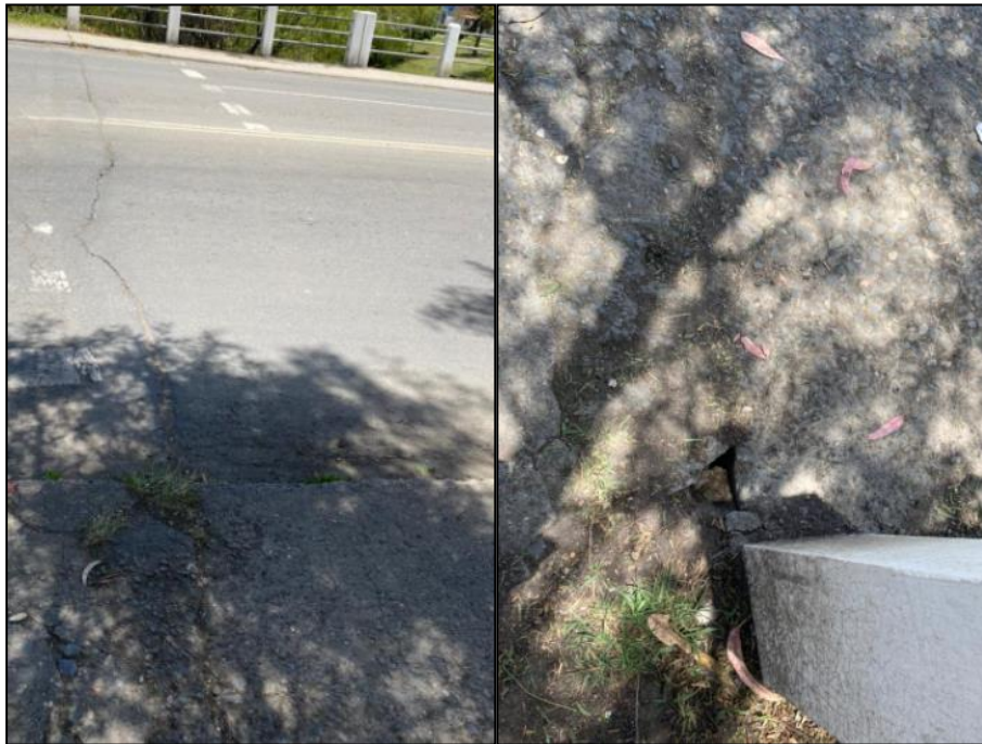
Imagen 99 Grietas en calzada y veredas del puente
