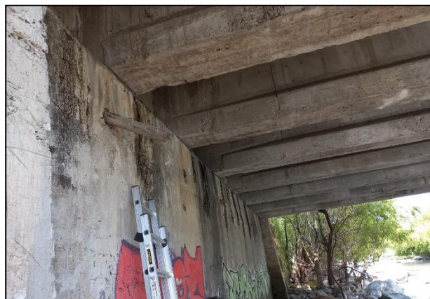
Imagen 39. Eflorescencia en el estribo.
