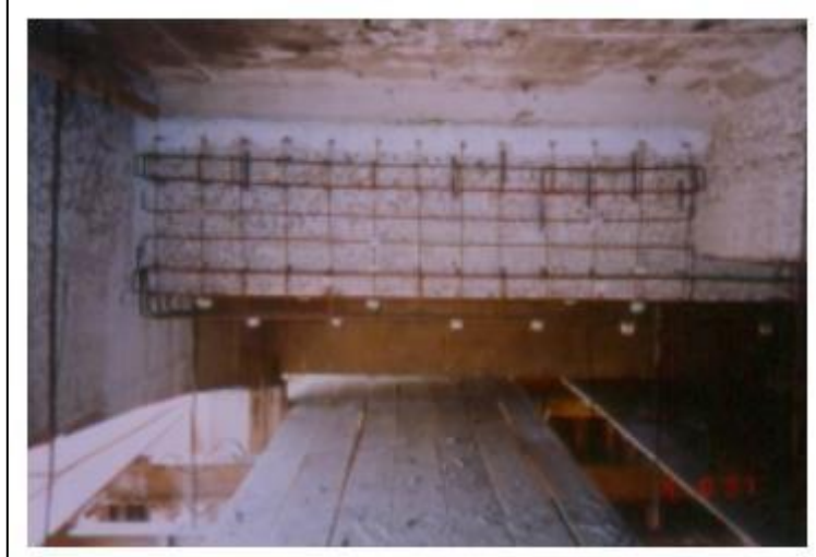
Imagen 148 Parte inferior de un puente escarificado Fuente: (Helene & Pereira, 2003)
