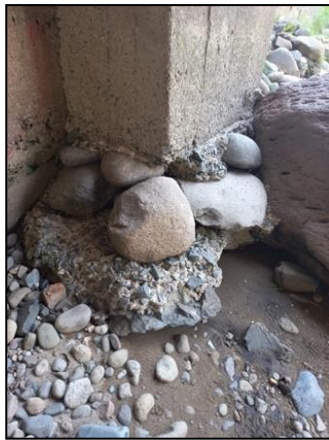
Imagen 38. Daño en la cimentación del estribo.
