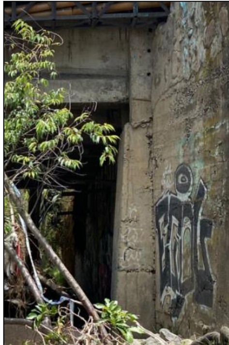
Imagen 97 Grietas en estribo derecho de puente
