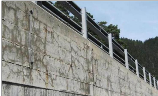
Imagen 4 Humedad en estructuras Fuente: (Constructivo, 2019)
