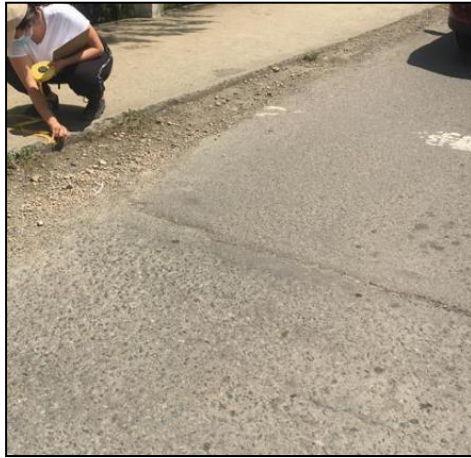
Imagen 37. Fisura transversal en la calzada.
