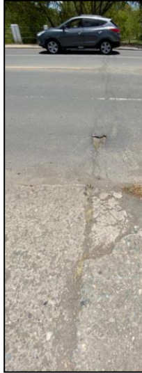
Imagen 101 Fisura en calzada del puente
