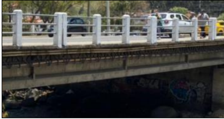
Imagen 100 Flexión de la plataforma del puente
