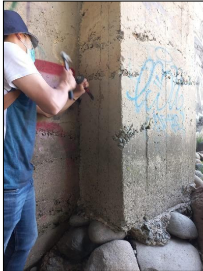
Imagen 55. Ruptura del Hormigón.
