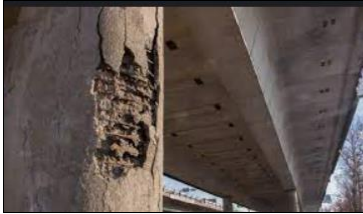
Imagen 3 Abombamiento por temperatura Fuente: (Escuela online de seguros de construccion, 2015)
