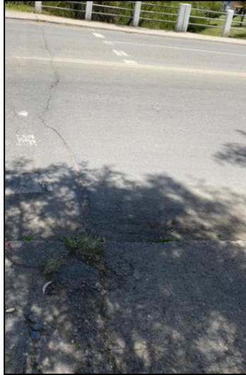
Imagen 7 Grietas en plataforma de puente Fuente: (Basset Salom, 2011)
