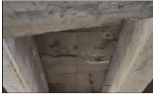
Imagen 107 Eflorescencias y desprendimientos
