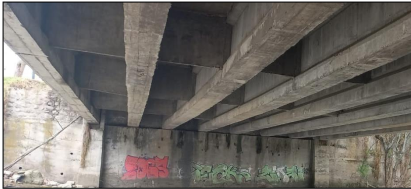
Imagen 103 Desprendimientos y fisuras en las ménsulas de apoyo
