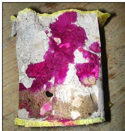
Imagen 13 Muestra de Hormigón carbonatado Fuente: (Fernández, 2014)
