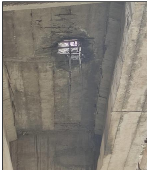
Imagen 138 Corrosión evidente en armadura de plataforma
