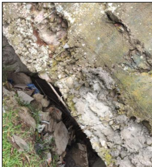
Imagen 102 Desprendimiento de recubrimiento
