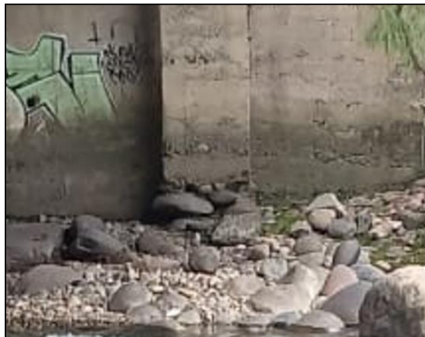
Imagen 98. Deterioro de la cimentación del puente.
