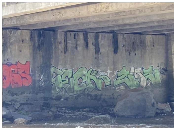
Imagen 105 Humedad en estribo de puente
