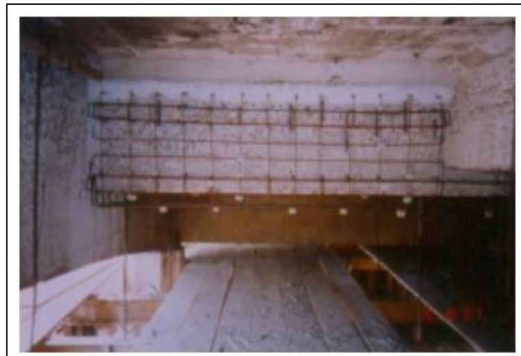
Imagen 198 Parte inferior de un puente escarificado Fuente: (Helene & Pereira, 2003)
