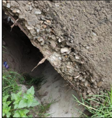
Imagen 104 Varillas corroídas en estribo superior
