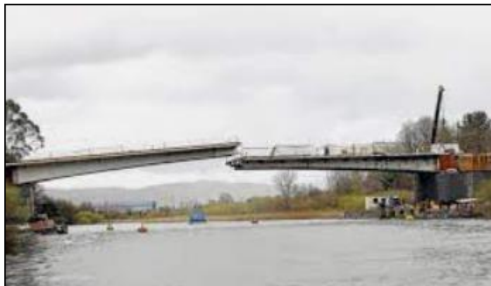
Imagen 2 Errores constructivos Fuente: (Pacheco-Rivas, 2017)
