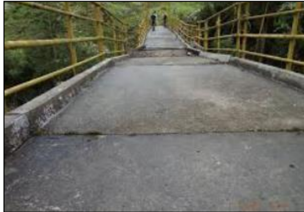
Imagen 9 Asentamientos diferenciados Fuente: (AN Ingenieros y Consultores, 2021)
