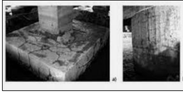
Imagen 5 Reacción Álcali-Agregado Fuente: (Sánchez de Guzmán, 2011)
