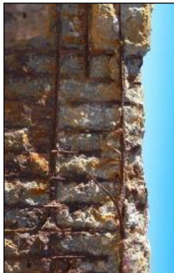
Imagen 6 Corrosión de acero de refuerzo en estribo Fuente: (Muñoz Castillo, 2020)
