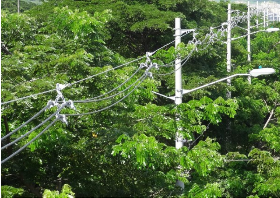
Figura 3.41: Mejoramiento del espacio arbolado con una red aérea semiaislada compacta [11].
