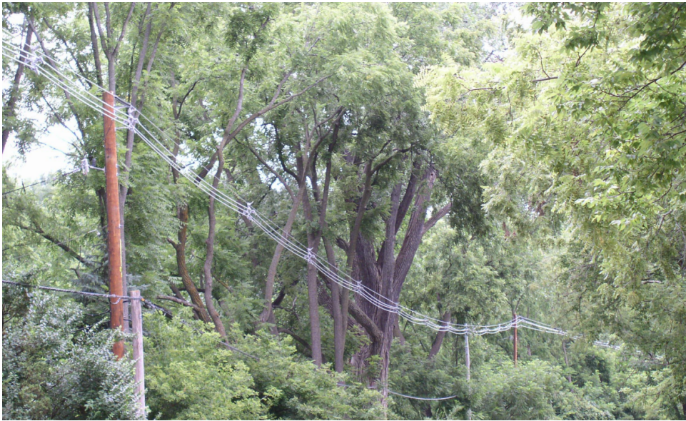
Figura 3.1: Red aérea semiaislada compacta de medio voltaje [7].
