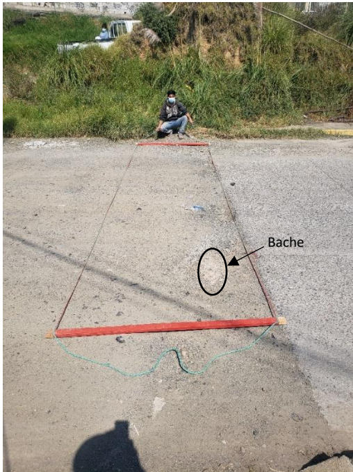
Foto 1. Baches dentro del cuadrante de medición
