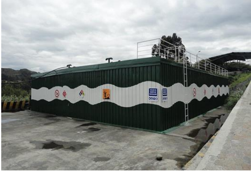
Figura 5. Tanque de almacenamiento de aceite mineral usado de 1000m 3 . ETAPA EP.
