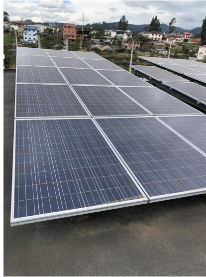
Figura 4.3: Sistema Fotovoltaico Ubicado en la parte superior de una estructura
