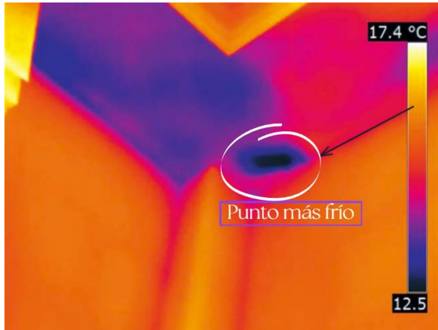
Fig. 2.13. Termograma de una habitación con humedad. [2]
