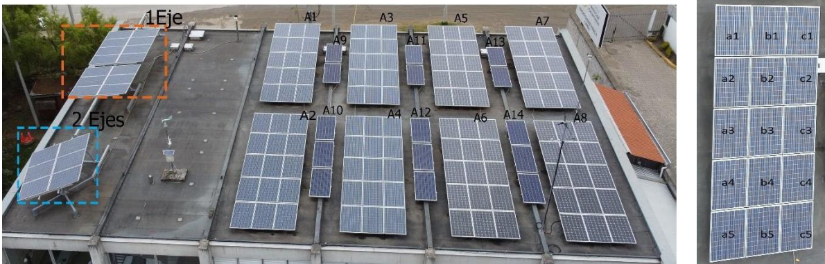
Fig. 3.5. Distribución de los paneles fotovoltaicos y su numeración.
