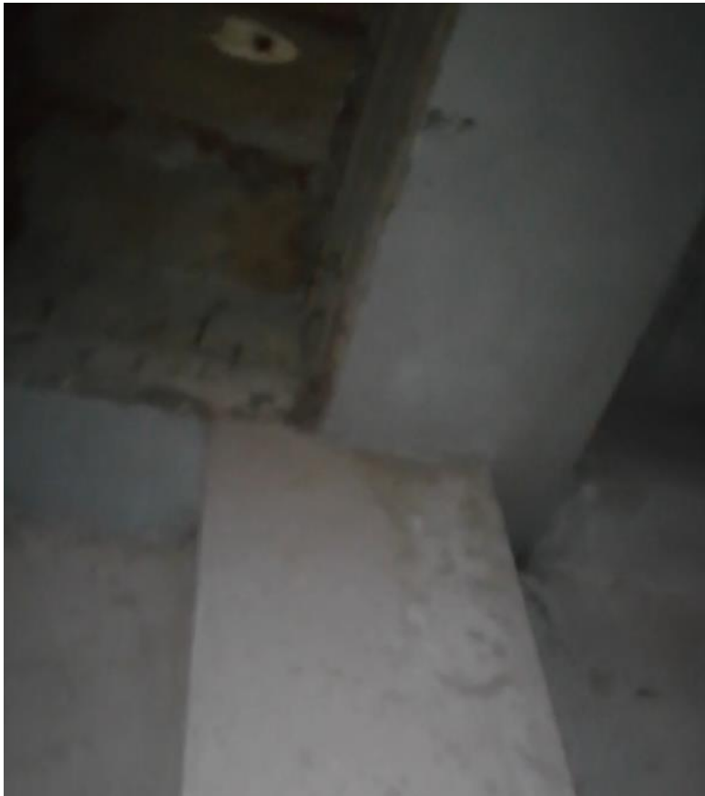
Ilustración 27: Mala construcción de unión viga - columna
