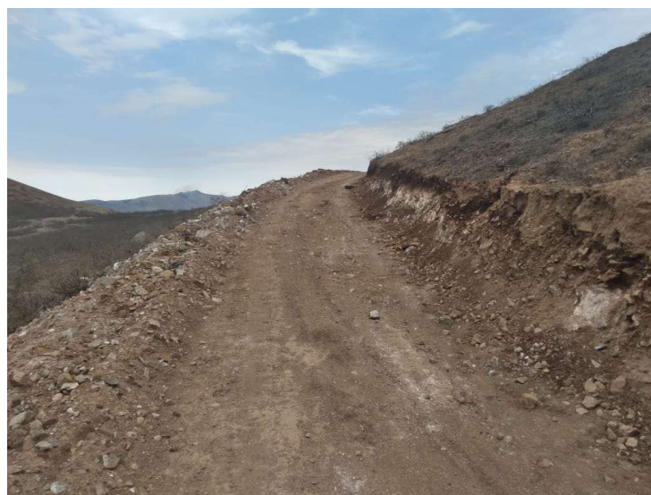
Ilustración 4. Existencia de pendientes longitudinales pronunciadas en trocha abierta hacia Yunquil
