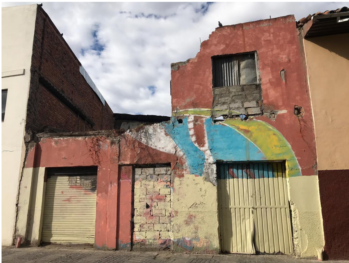
Figura 10. Casa en ruinas diagonal a La Plazoleta Fuente: Propia
