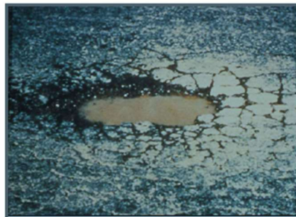
Figura 2.13: Bache de alta severidad [15].
