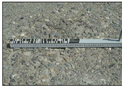
Figura 2.21: Pérdida de agregado grueso por desintegración del pavimento [15].
