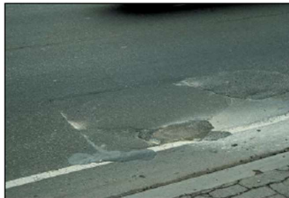
Figura 2.11: Deterioro de parche de alta severidad [15].
