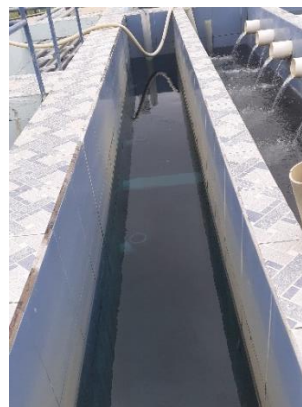
Figura 32. Canal de recolección de agua prefiltrada (floculador de flujo horizontal) Fuente: Autores
