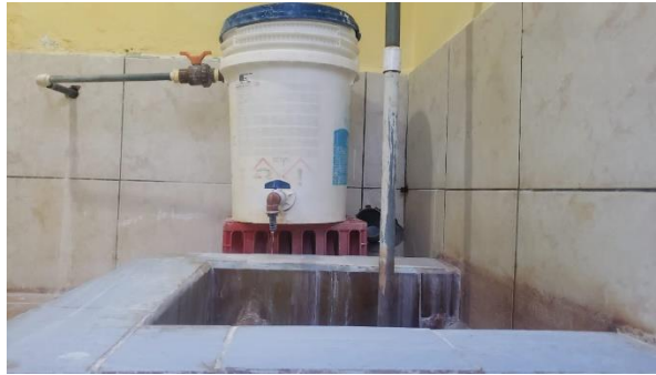
Figura 35. Sistema de goteo directo de hipoclorito de calcio Fuente: Autores
