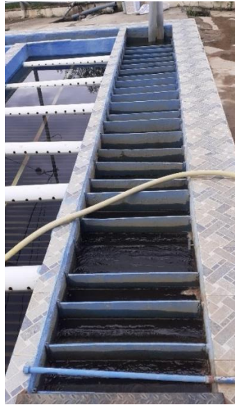
Figura 25. Floculador hidráulico de flujo vertical Fuente: Autores
