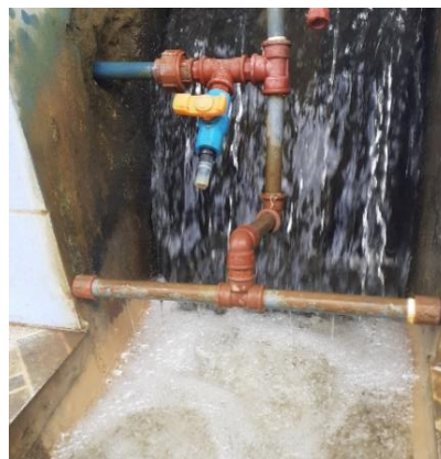
Figura 23. Flauta de dosificación de coagulante Fuente: Autores
