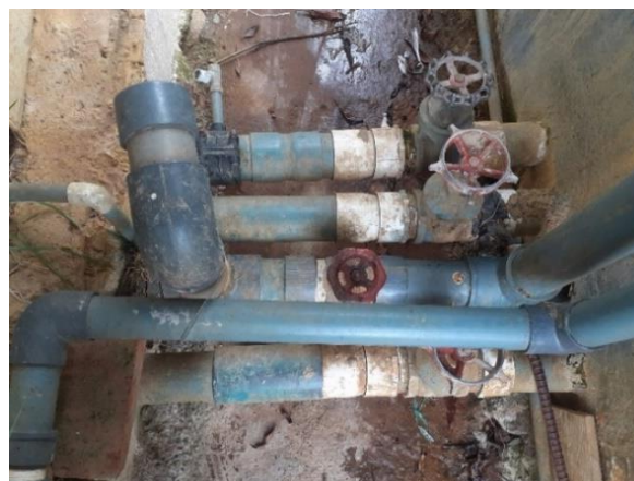
Figura 20. Válvulas de ingreso de agua cruda Fuente: Autores
