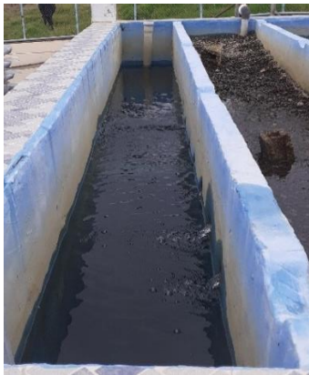
Figura 31. Canal de recolección de agua prefiltrada (floculador de flujo vertical) Fuente: Autores
