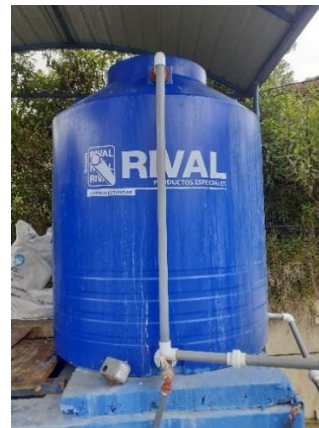
Figura 22. Tanque de 1000 litros de capacidad para la preparación del policloruro de aluminio Fuente: Autores
