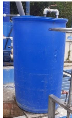
Figura 27. Tanque de 200 litros de capacidad para la preparación del polímero catiónico Fuente: Autores
