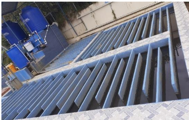
Figura 24. Floculador hidráulico de flujo horizontal Fuente: Autores
