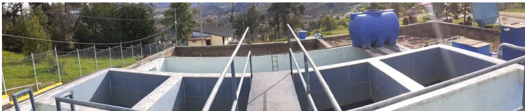
Figura 33. Batería de filtros rápidos Fuente: Autores
